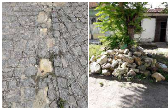
[Figura 46] Estado de conservação Fonte: Autor, 2019
