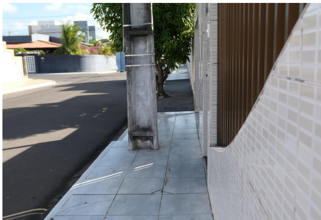
Figura 19: Poste dificultando a caminhabilidade na calçada.
