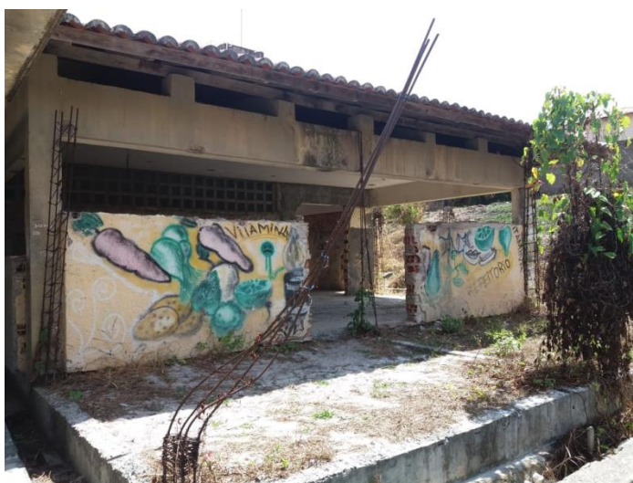
Imagem 8: Sala de aula deteriorada do Colégio Estadual Olavo Bilac, Aracaju-SE Fonte: Acervo pessoal do professor Douglas Leoni Rodrigues Melo da Silva, 2017.
