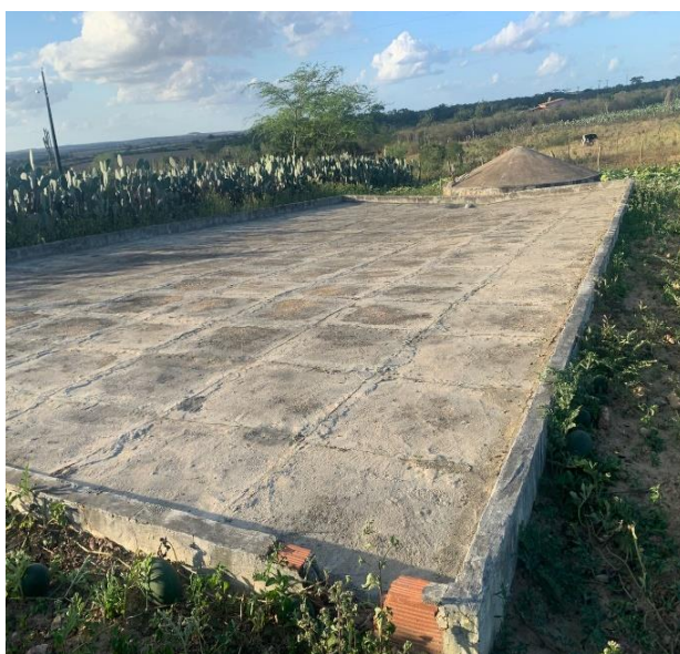
Figura 39: Cisterna Calçadão, em uma pequena propriedade no povoado Couro - Monte Alegre de Sergipe, 2020
