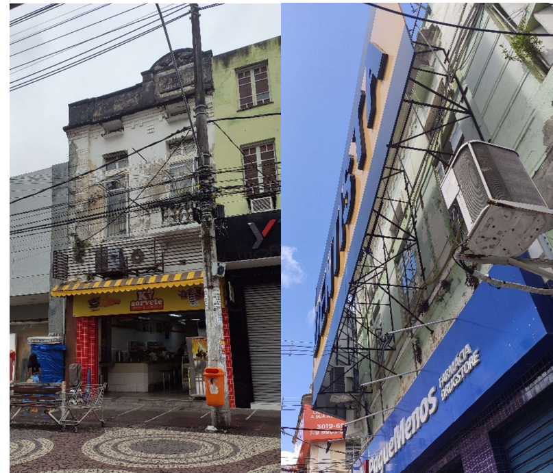
Figuras 67 e 68 – Desgaste superficial nos edifícios históricos
