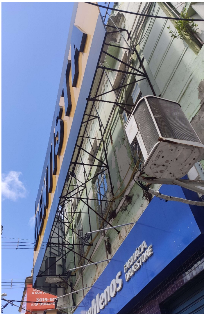
Figura 11 – O uso de estruturas autoportantes em anúncios publicitários e o desgaste superficial da edificação, presente no Calçadão de Aracaju.
