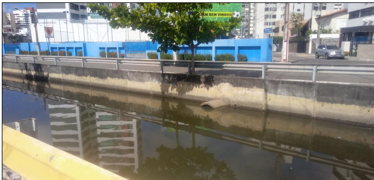
Figura 13 - Tubulação de drenagem com possibilidade de retorno devido efluentes ao nível da tubulação.
