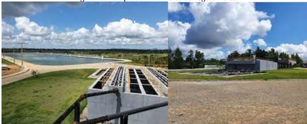
Figura 16: Estação de Tratamento de Esgoto Dorés.
