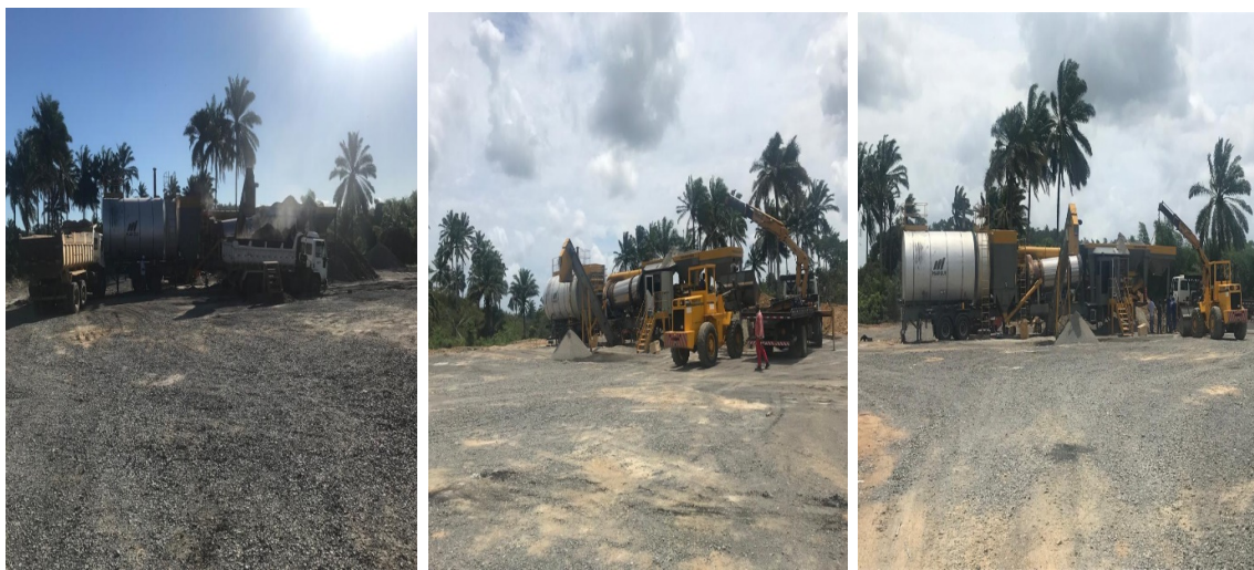
Figura 6. Usina de asfalto
