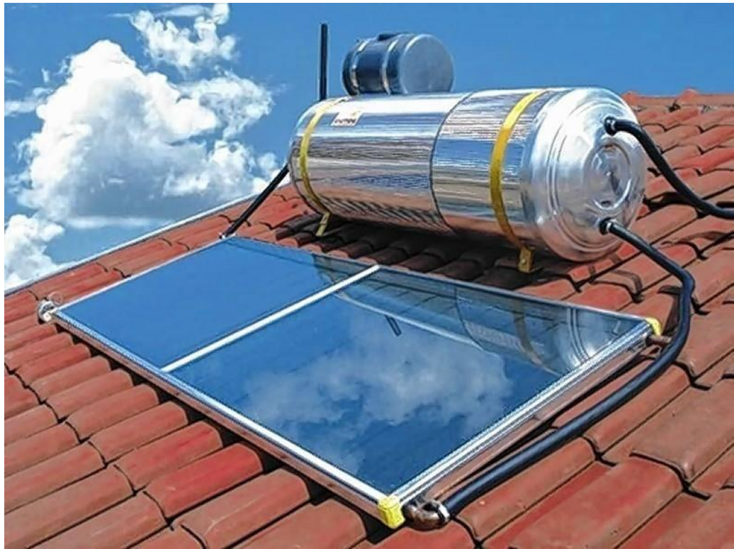
Figura 6 – Sistema de aquecimento solar de água – boiler
