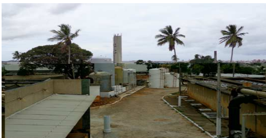
Figura 6 – Armazenamento em silos de produtos químicos da ETA João Ednaldo
