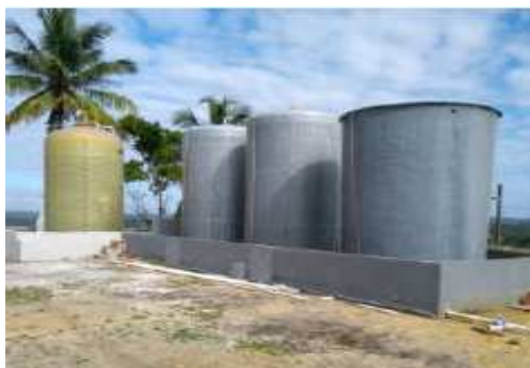
Figura 4 – Armazenamento em silos de produtos químicos da ETA Cabrita
