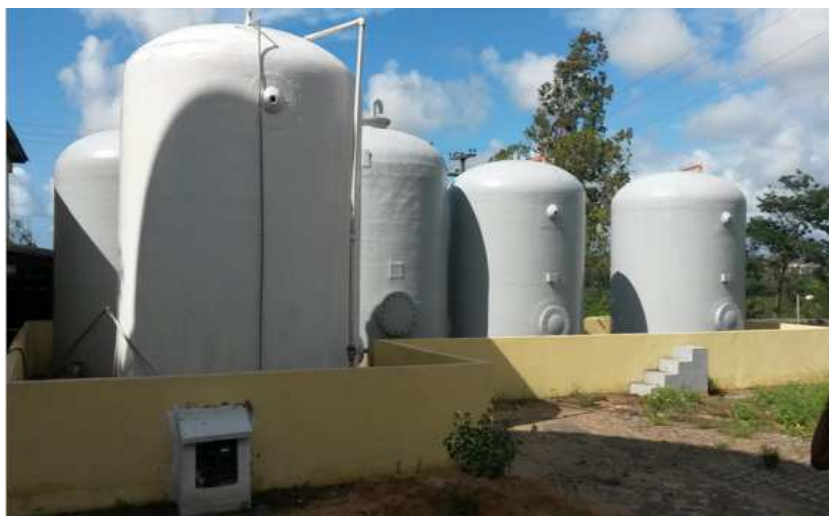
Figura 2 – Armazenamento em silos de produtos químicos da ETA Poxim
