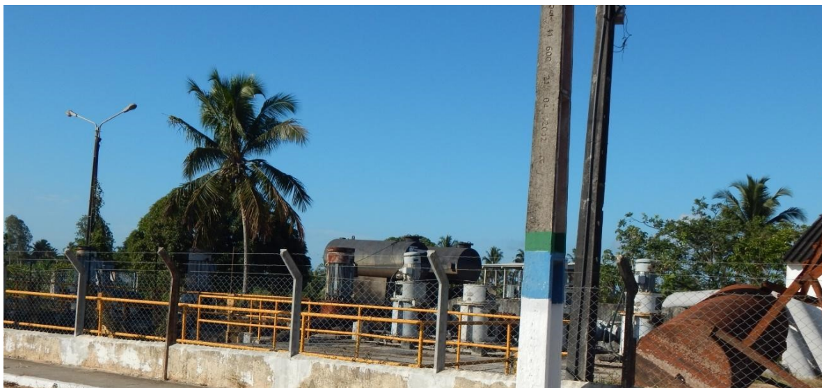
Figura 49: Unidade de bombeamento de água em Ilha das Flores/SE
