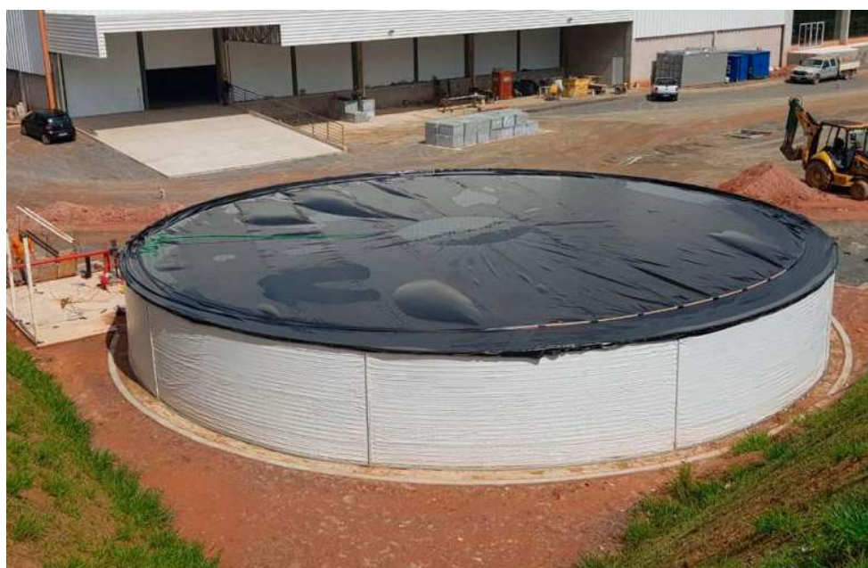
Figura 16 – Cisterna de metal galvanizado para reaproveitamento da água da chuva.
