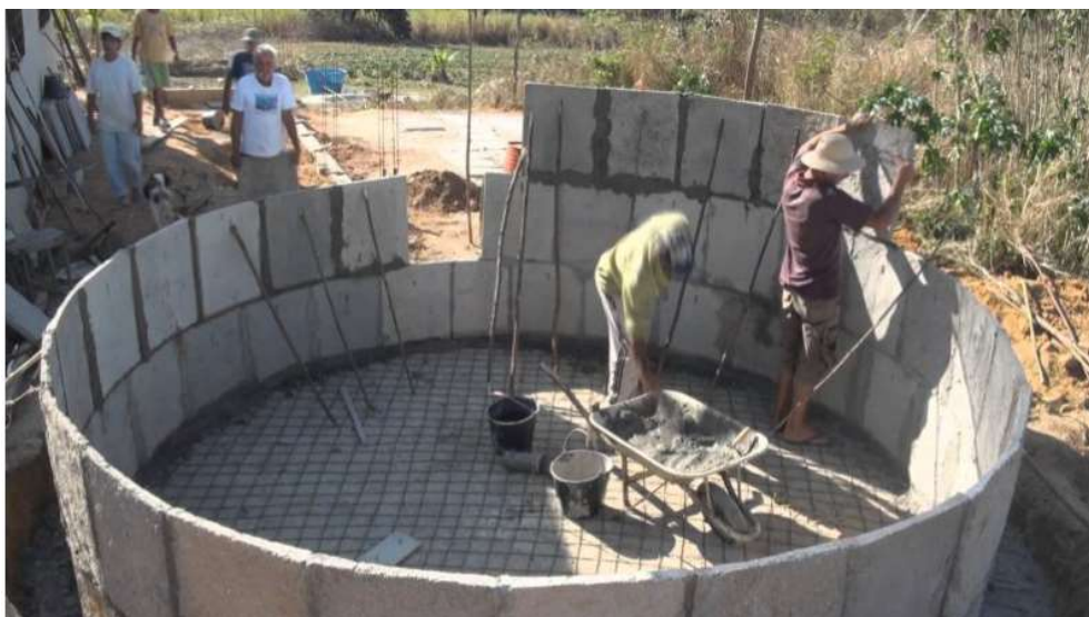
Figura 15 – Cisterna de concreto para reaproveitamento da água da chuva.
