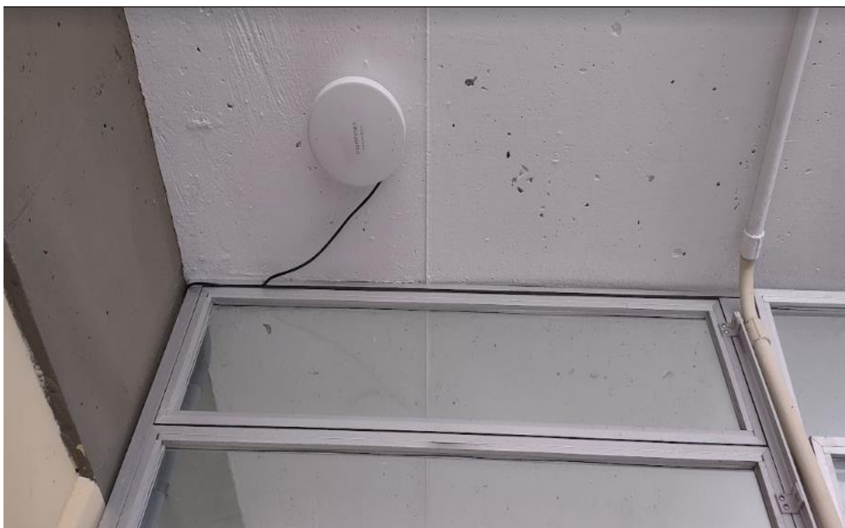
Figura 19: Roteador instalado no teto da sala de aula
