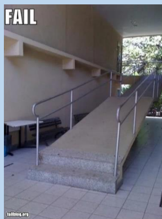
Figura 11: Barreira arquitetônica, exemplo de uso incorreto de rampa com degraus.
