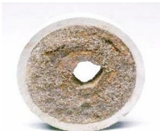
Figura 5 – Fotografia de deposição de parafina nas paredes da tubulação.
