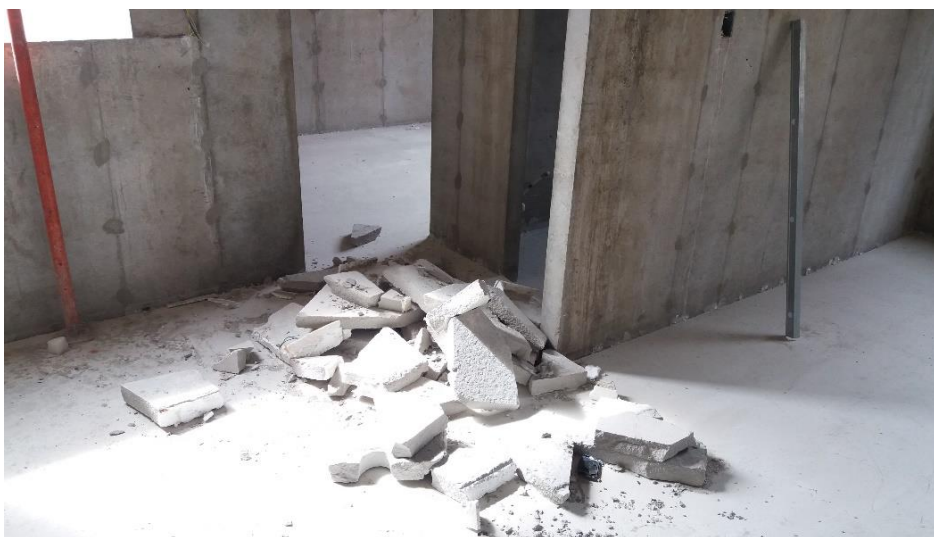
Figura 38: Retrabalho por conta de patologias no contrapiso autonivelante.
