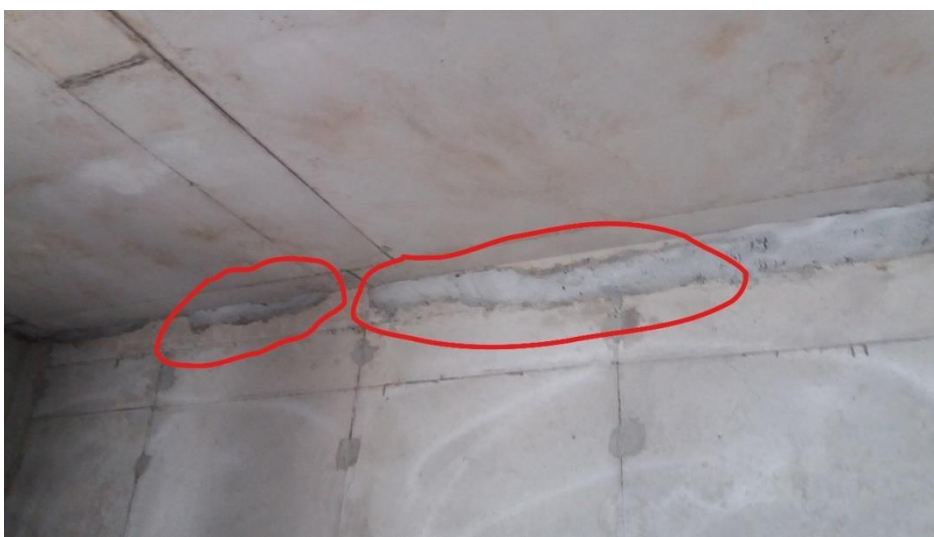
Figura 27: Exemplo de problemas nas paredes de concreto: falta de estanqueidade das fôrmas .
