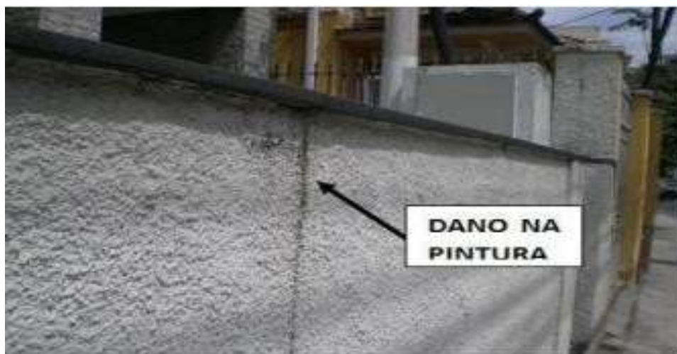
Figura 11 – Surgimento de manchas no muro devido à umidade
