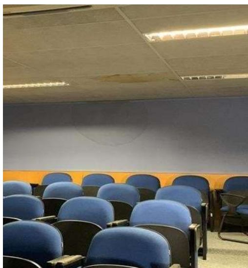
Figura 15 – Infiltração no forro e paredes internas dos ambientes
