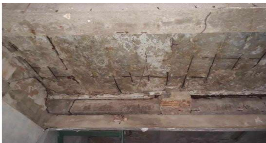
Figura 7 – Corrosão de armaduras
