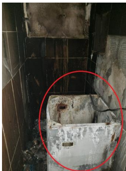
Figura 58: Foco Inicial determinado (máquina de lavar) com deslocamento de revestimento cerâmico
