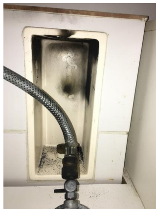
Figura 83: Fuligem no local do regulador de pressão e mangueira de Gás Natural
