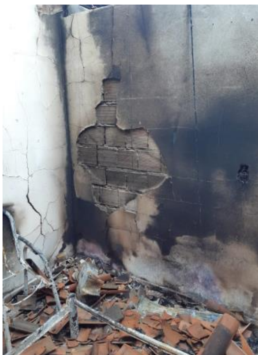
Figura 71: Desplacamento de reboco
