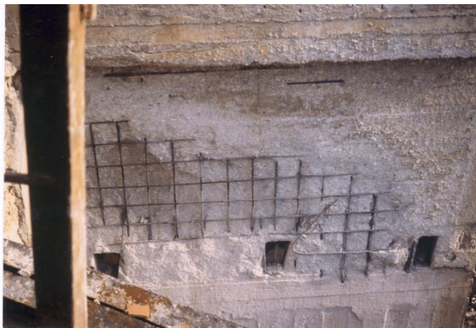
Figura 37: Spalling em parede de concreto armado
