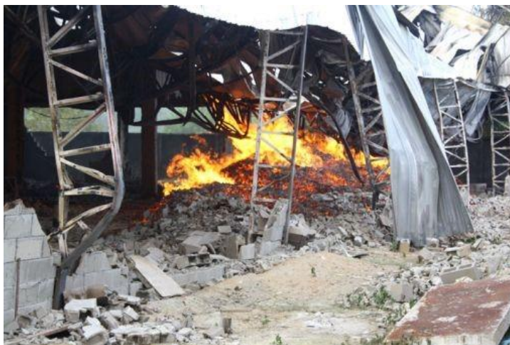
Figura 38: Empenamento do aço na treliça esquerda
