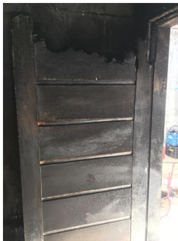
Figura 63: Decomposição térmica na parte superior da porta
