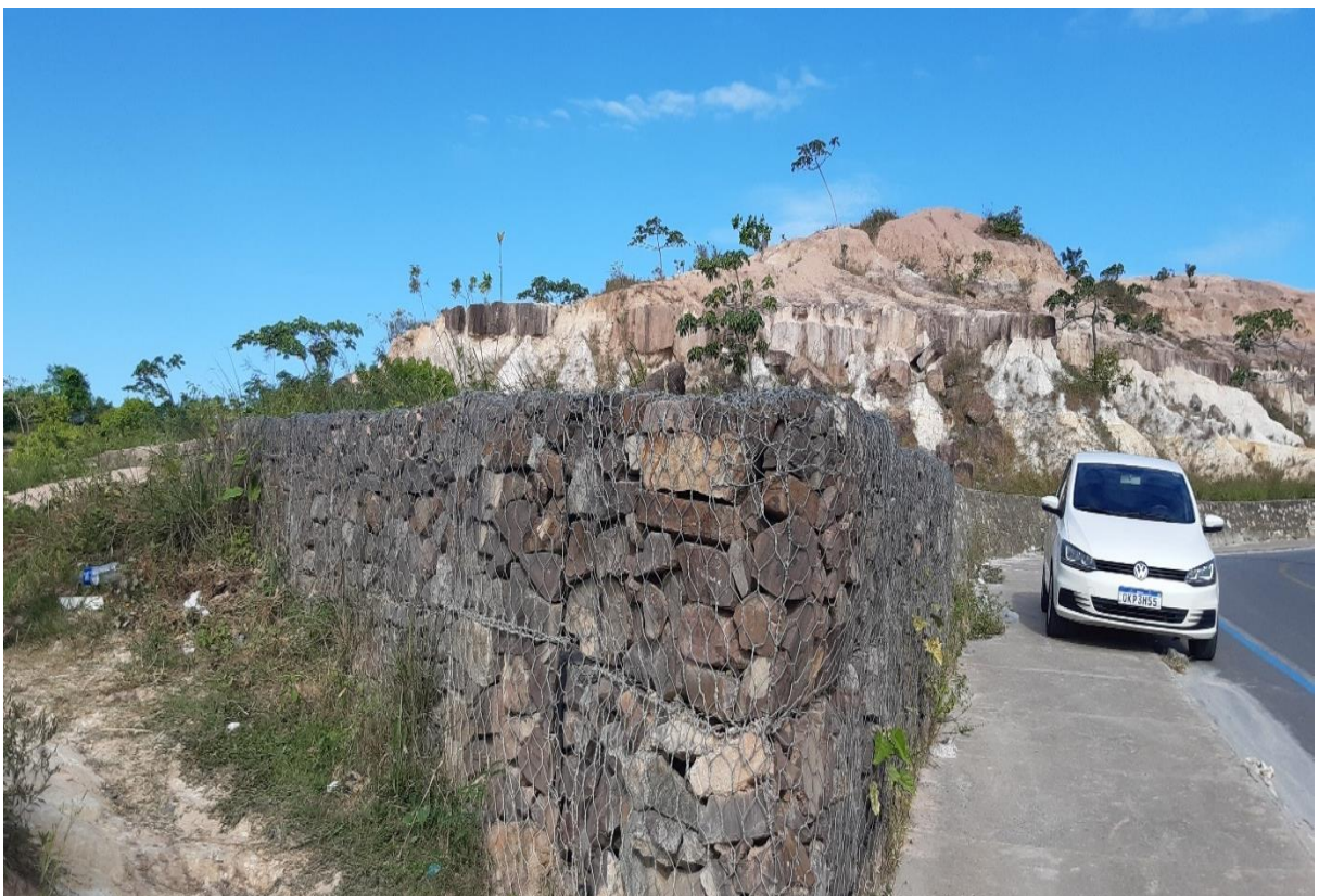
Figura 96: Muro de gabião como obra de contenção aos escorregamentos translacionais em encosta de morro na rua D do Bairro Cidade Nova.
