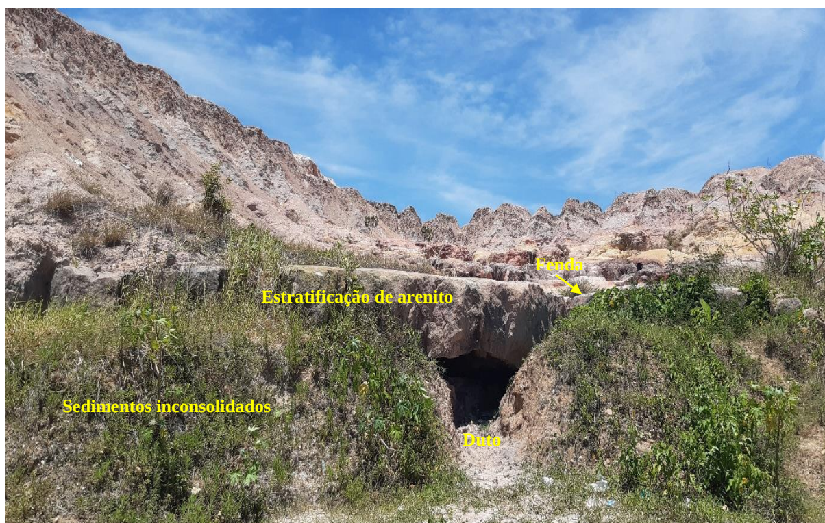
Figura 71: Situação da mesma encosta (2023 - Fig. 70) evidenciando intensificação do processo erosivo com perdas significativas de sedimentos. Nota-se a presença de duto na base da encosta ravinada com acumulação de sedimentos arenoargilosos carreados do seu interior. No patamar superior delimitado pela estratificação de arenito consolidado formou-se uma zona de deposição de sedimentos já consolidados abaixo das cabeceiras das ravinas.
