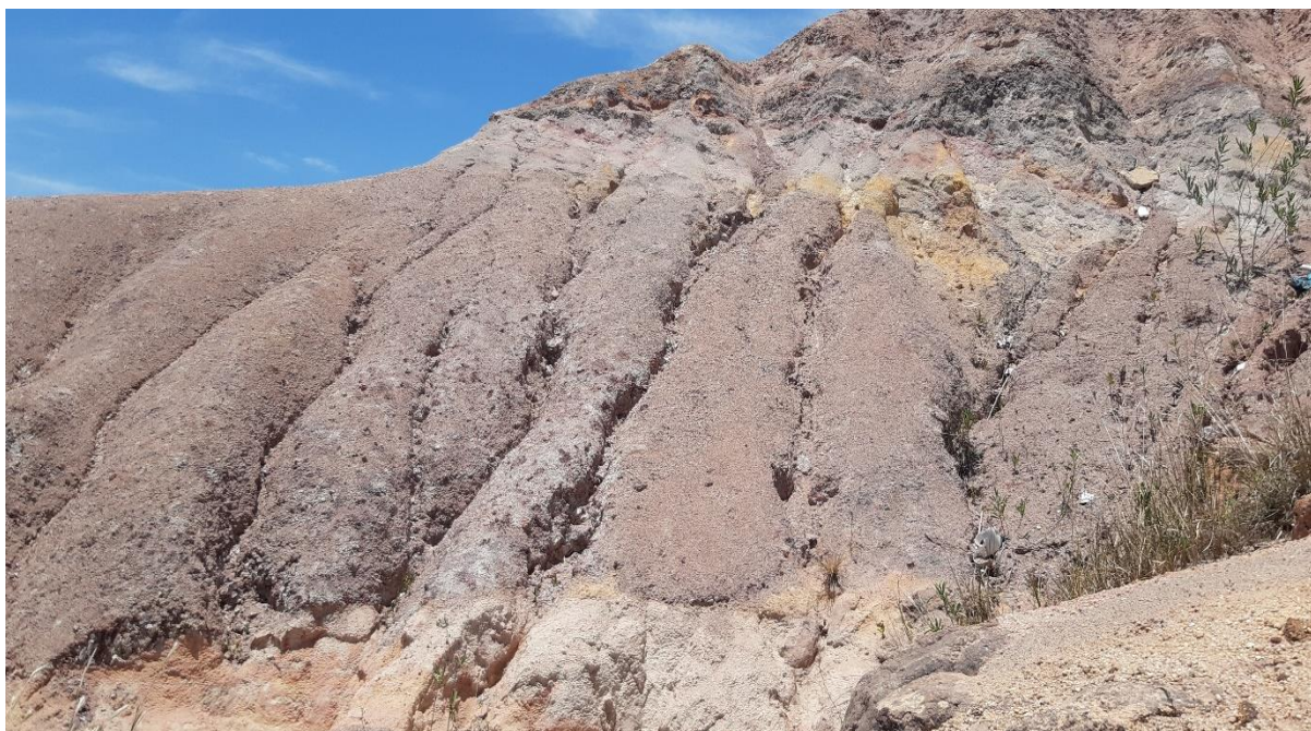
Figura 60: Formação de sulcos evidenciando o início do escoamento superficial sobre o material saturado da encosta. Rua São Francisco, Bairro Cidade Nova.
