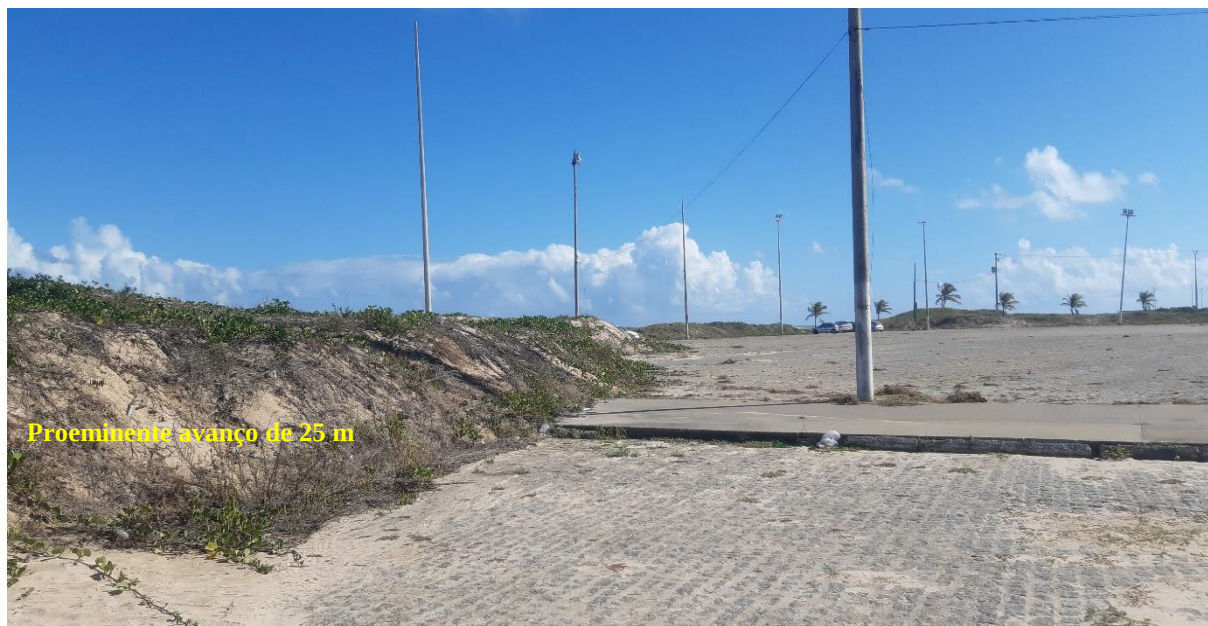
Figura 37: Praça de eventos da Orla de Atalaia parcialmente destruído pelo impacto da erosão em 2008. Observa-se o avanço da deposição sedimentar edificando um cordão dunar na área erodida.
