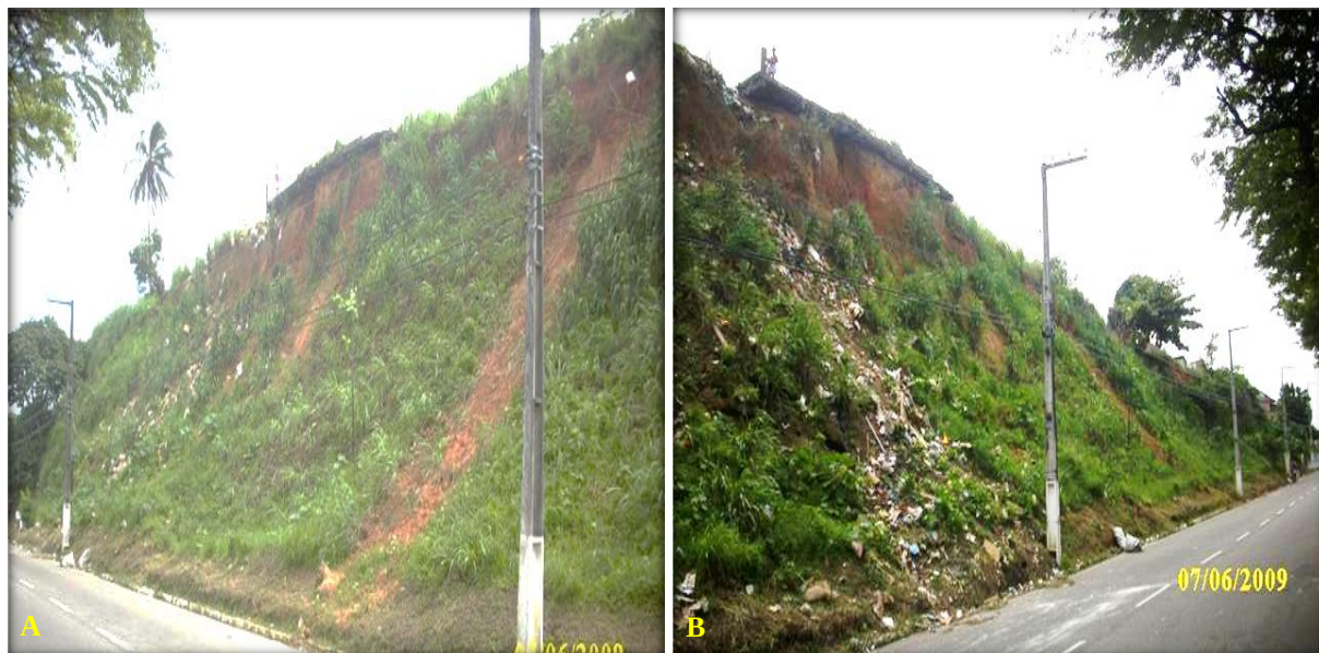
Figura 78: A e B – Deslizamentos de terra no período chuvoso, expondo risco para as residências assentadas no terço superior, em encosta localizada na Av. Dr. José da Silva Ribeiro Filho, Bairro América.
