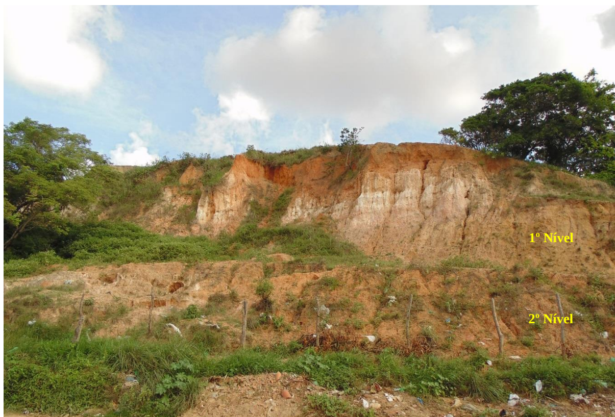
Figura 59: Evolução de feições erosivas sob o efeito do escoamento laminar e linear nos dois níveis da encosta (transição de sulcos para ravinas – estágio 1), Av. Gen. Euclides Figueiredo, Bairro Japaozinho.
