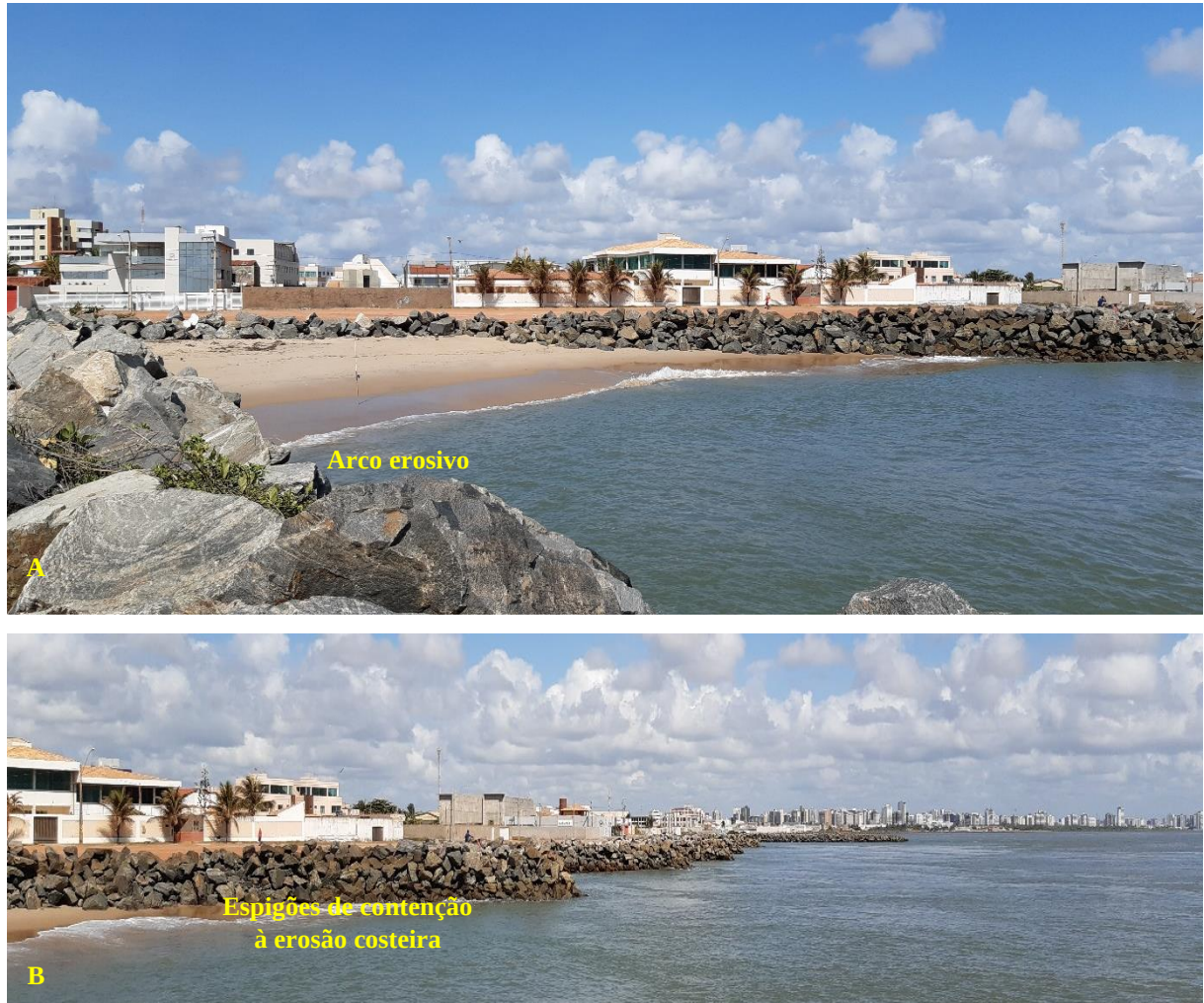
Figura 35 A e B: Sinais evidentes de erosão costeira severa abrangendo trecho da praia dos Artistas e margem direita do rio Sergipe, Bairro Coroa do Meio.
