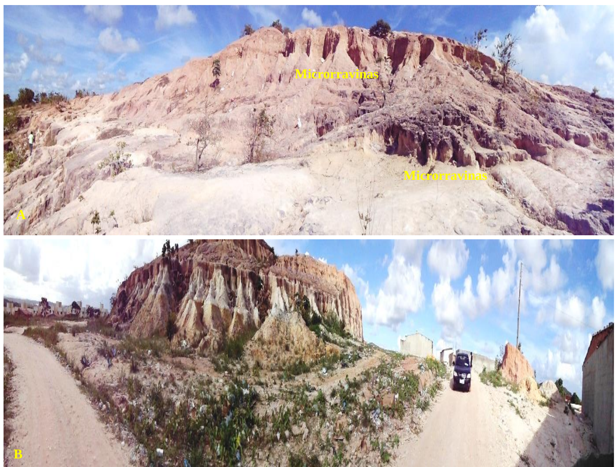
Figura 69: A e B – Vista panorâmica de encostas sem o revestimento da cobertura vegetal, exibindo o desenvolvimento de microrravinas (terceiro estágio), entre as ruas D e São Francisco no Bairro Cidade Nova.
