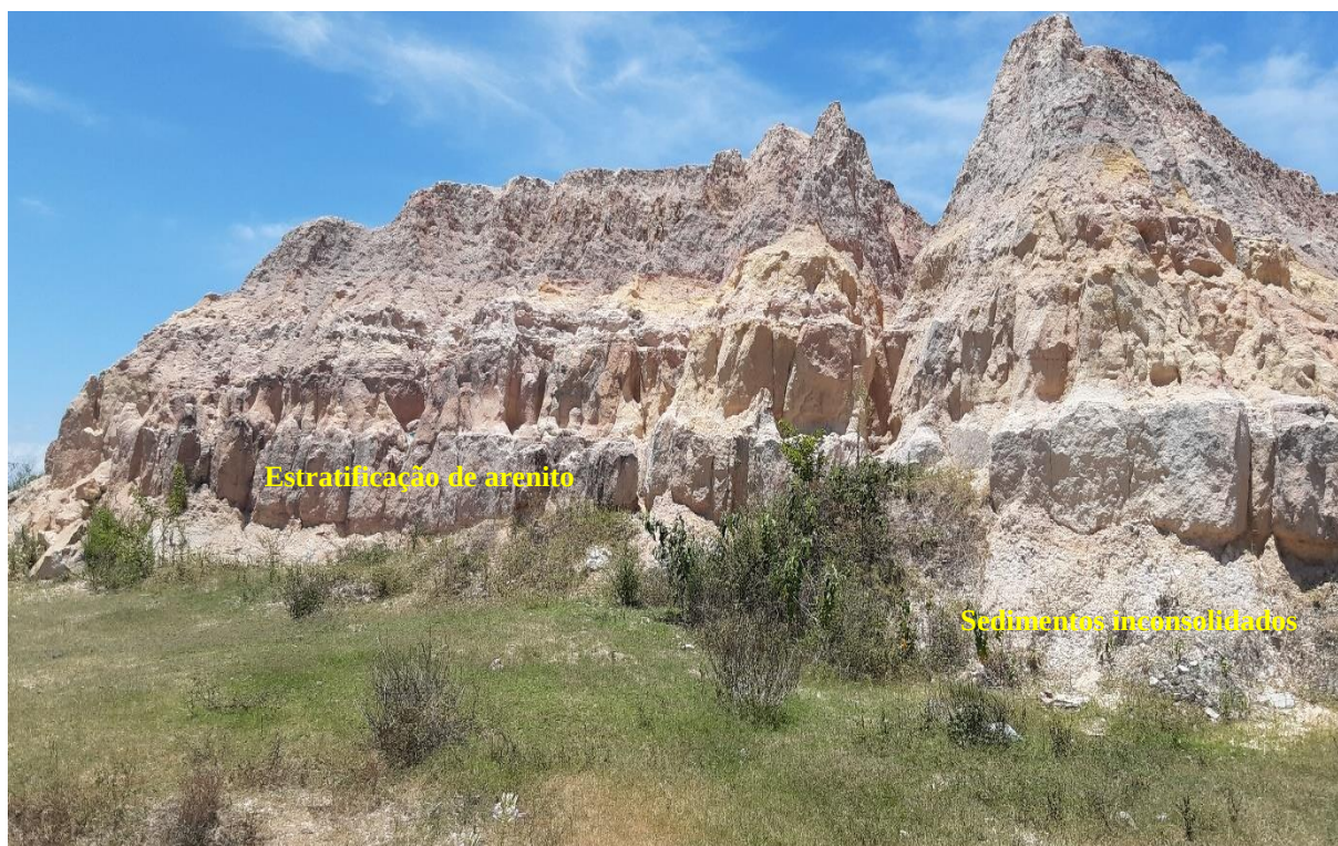
Figura 63: Efeitos do escoamento superficial concentrado em encosta íngreme da rua São Francisco, Bairro Cidade Nova. Observa-se a presença de fissuras longitudinais nos terços médio e inferior, além dos depósitos de sedimentos arenoargilosos inconsolidados e não coesivos pela exposição à chuva, em toda extensão da base, no limite com a estratificação de arenito.
