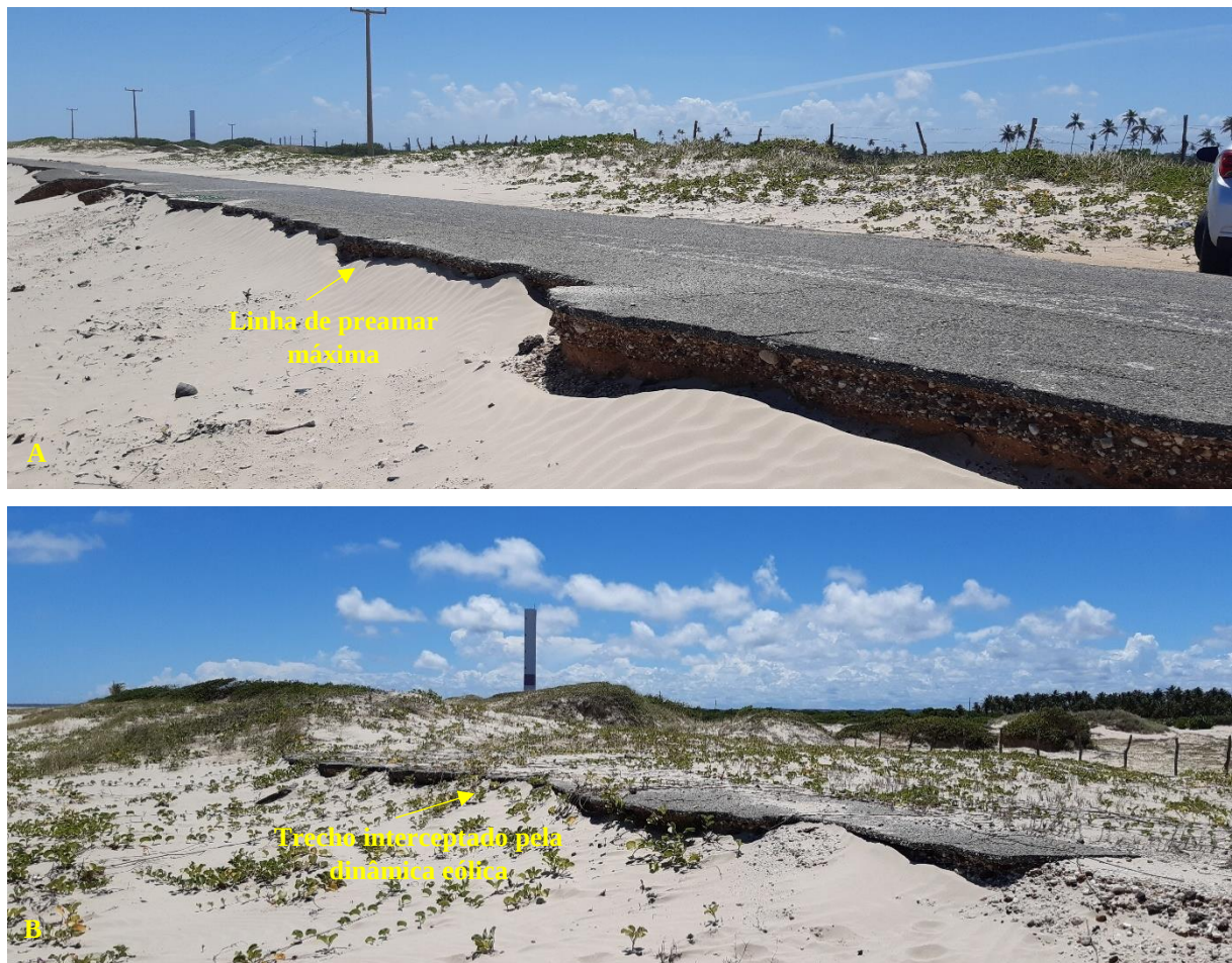
Figura 38 A e B: Destruição de trecho final da rodovia José Sarney pela erosão costeira, praia do Mosqueiro. Créditos: Rafael da Cruz e Hélio Mário de Araújo, 2021.
