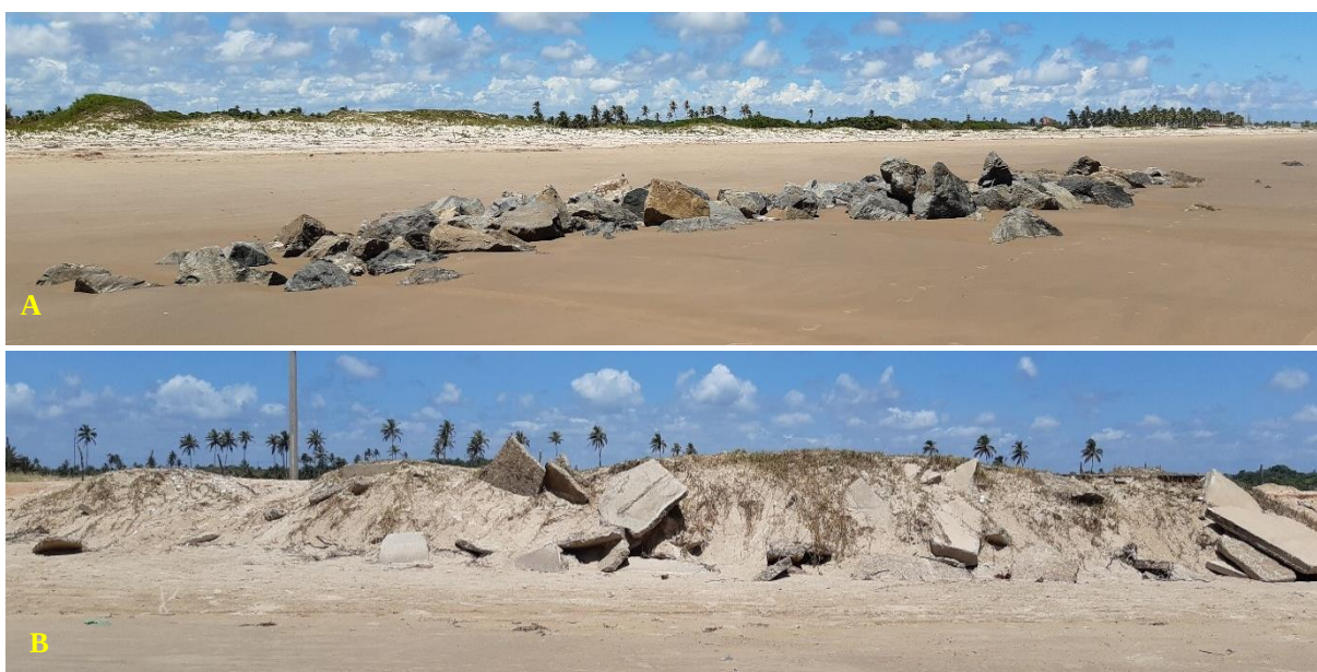
Figura 48: A e B – Remanescentes de estruturas fixas expostos na face praial evidenciando os efeitos da erosão costeira severa.
