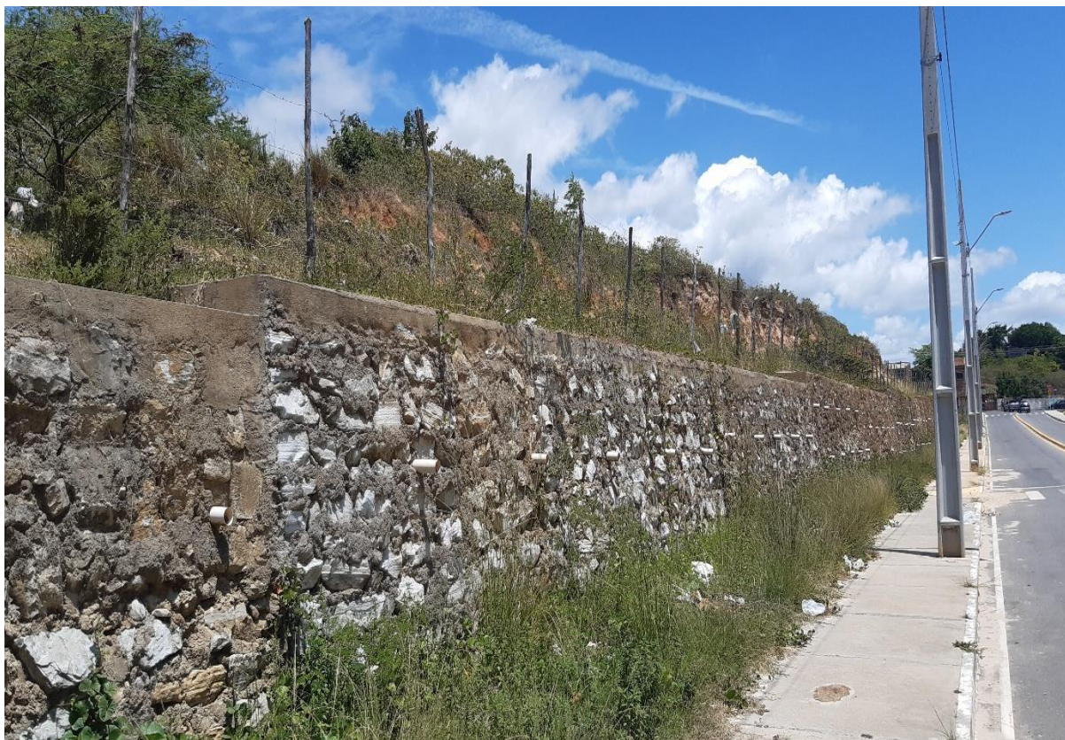
Figura 94: Muro de arrimo em encosta de baixo declive na Av. Antônio Barbosa de Jesus, Bairro Japaozinho. Créditos: Rafael da Cruz e Hélio Mário de Araújo, 2023.
