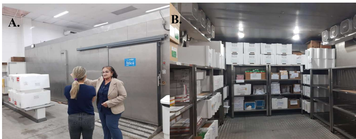
Figura 16. A. Setor de câmaras frias, CEADI-SES. B. Prateleiras de armazenamento de imunobiológicos, CEADI-SES.
