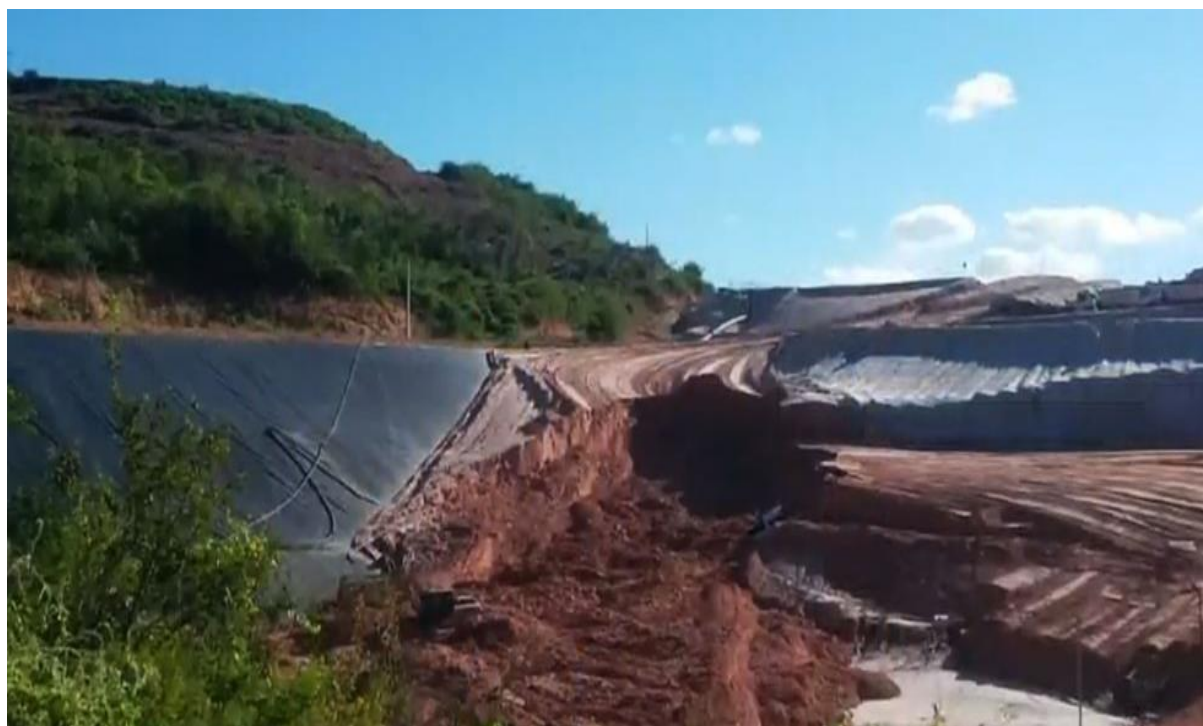
Figura 72: Desmoronamento de blocos de rejeitos de mineração na barragem 02, Jacobina/BA. Fonte: https://g1.globo.com/ba/bahia/noticia/2020/12/03/parte-interna-de-barragem-de-rejeitos-desaba-em-jacobina-e-atinge-veiculo.ghtml , Acesso em: 20 dezembro de 2020.
