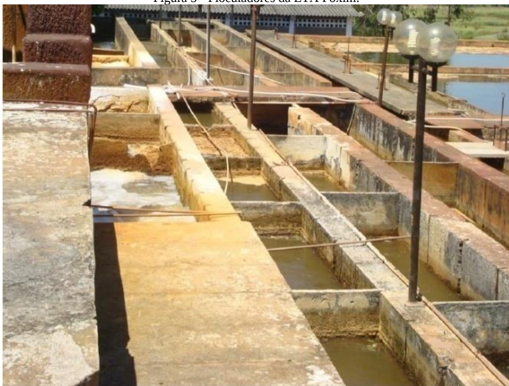
Figura 5 - Flocculadores da ETA Poxim.
