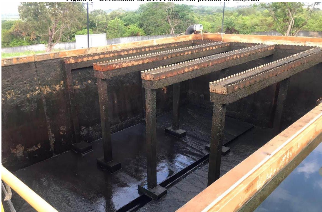
Figura 6 - Decantador da ETA Poxim em período de limpeza.
