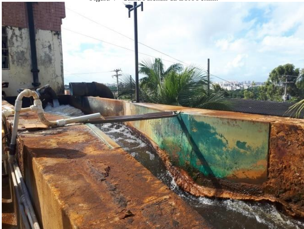
Figura 4 - Calha Parshall da ETA Poxim.
