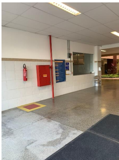
Figura 53 – Abrigo metálico para hidrante simples na entrada principal
