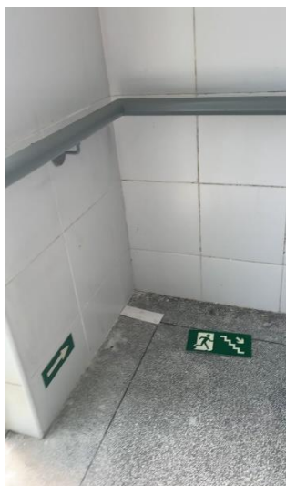
Figura 47 - Sinalização de orientação e salvamento, patamar do 2º pavimento
