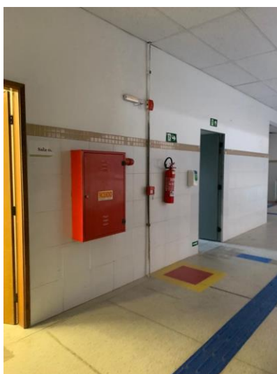
Figura 54 - Abrigo metálico para hidrante simples - 1º andar
