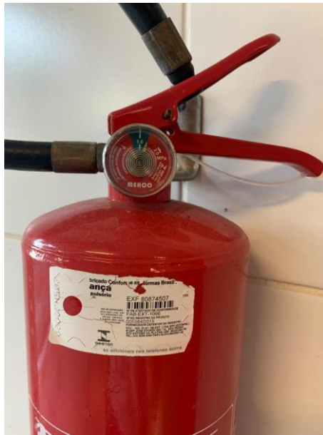
Figura 50 – Extintor localizado no térreo
