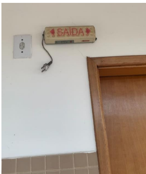
Figura 41 - Luminária de emergência desplugada da tomada
