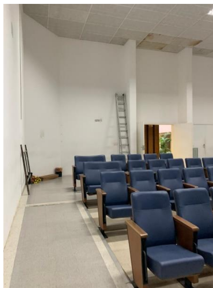
Figura 26 - Iluminação autônoma próximo a saídas de emergência central
