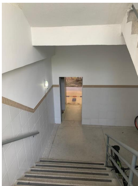
Figura 46 - Falta de sinalização na escada do térreo
