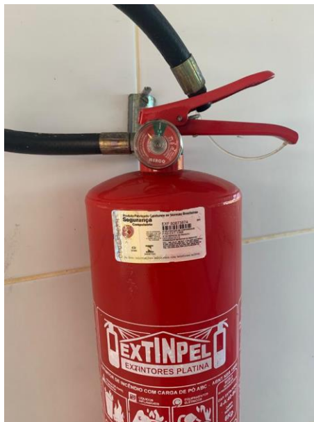
Figura 51 – Extintor despressurizado no 5º pavimento
