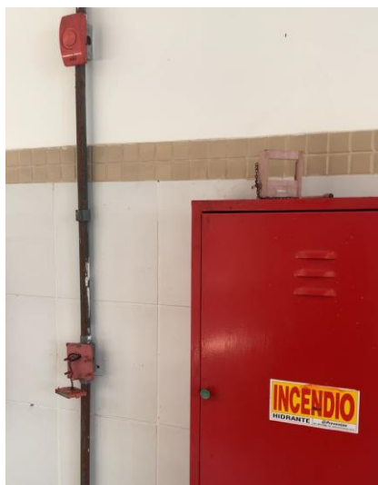
Figura 45 - Acionador de alarme quebrado no 3º pavimento
