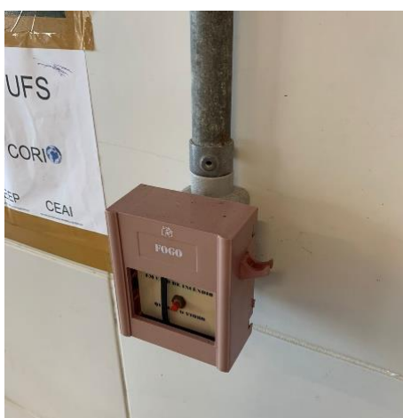
Figura 44 - Acionador de alarme próximo a recepção
