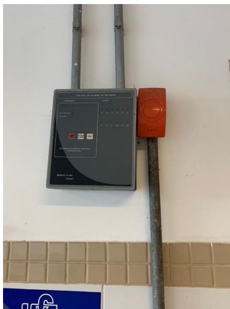
Figura 43 - Central de alarme
