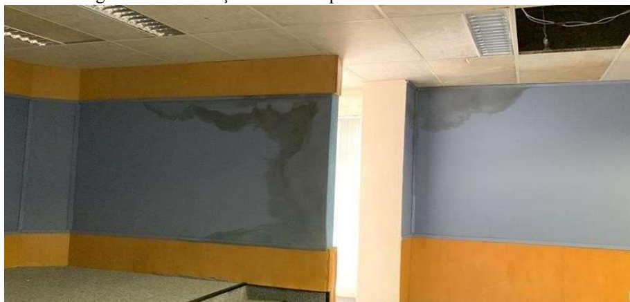
Figura 13 – Infiltração no forro e paredes internas dos ambientes
