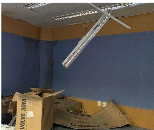
Figura 16 – Infiltração no forro e paredes internas dos ambientes
