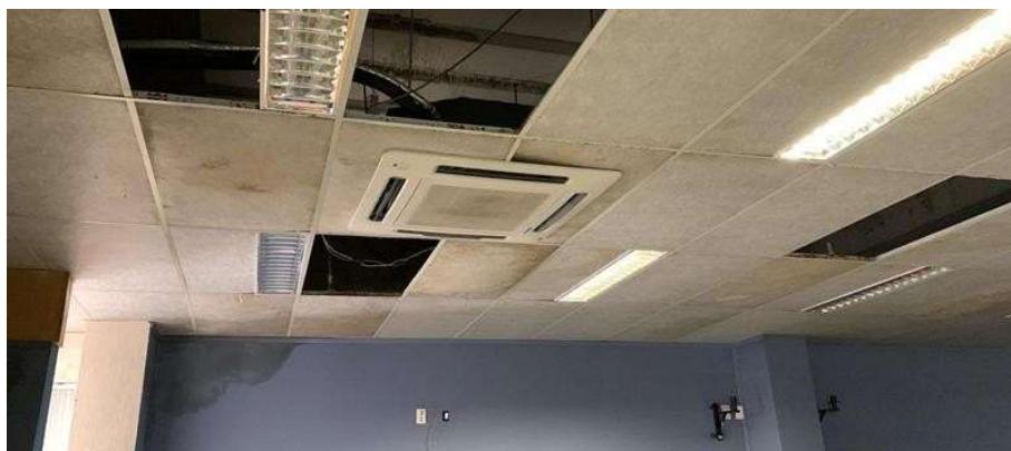
Figura 14 – Infiltração no forro e paredes internas dos ambientes
