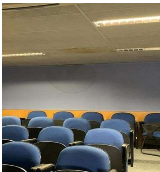
Figura 15 – Infiltração no forro e paredes internas dos ambientes
