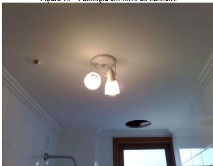
Figura 10 – Patologia em forro do banheiro
