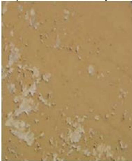
Figura 12 – Descascamento da pintura
