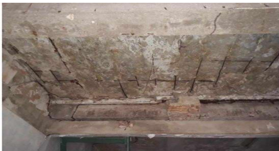
Figura 7 – Corrosão de armaduras
