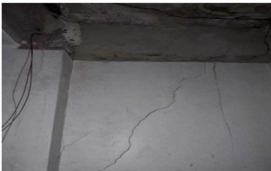
Figura 8 - Fissura na edificação
