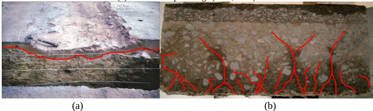
Figura 02: Danos em camadas cimentadas de pavimentos semirrígidos: (a) Esmagamento (DE BEER, 1990) e (b) Trincamento por Fadiga (YEO, 2008).
