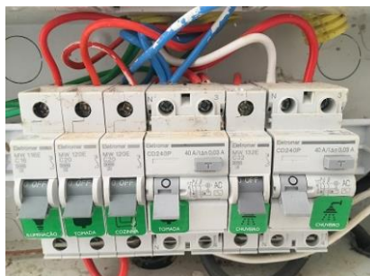
Figura 74: Quadro de disjuntores intactos
