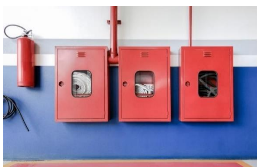
Figura 26: Terminais de hidrante de parede
