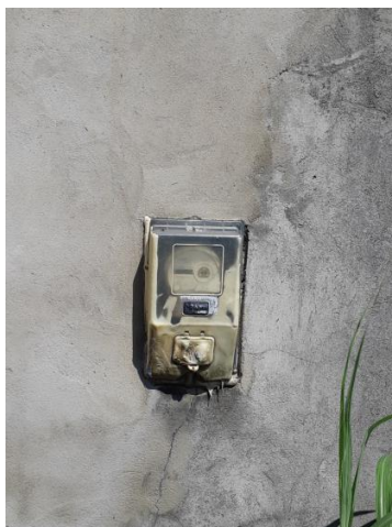
Figura 77: Medidor de energia com sinais de vandalismo (derretimento por agente acelerador de queima)
