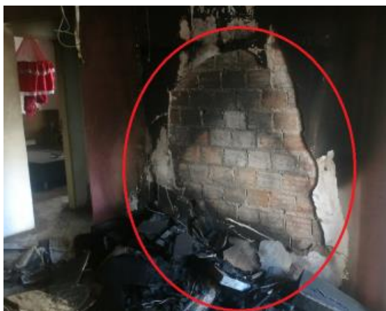
Figura 57: Foco Inicial determinado (televisor) com deslocamento de reboco
