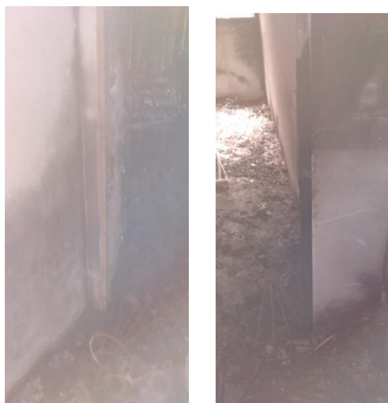
Figura 64: Marcas de combustão em batente de porta
