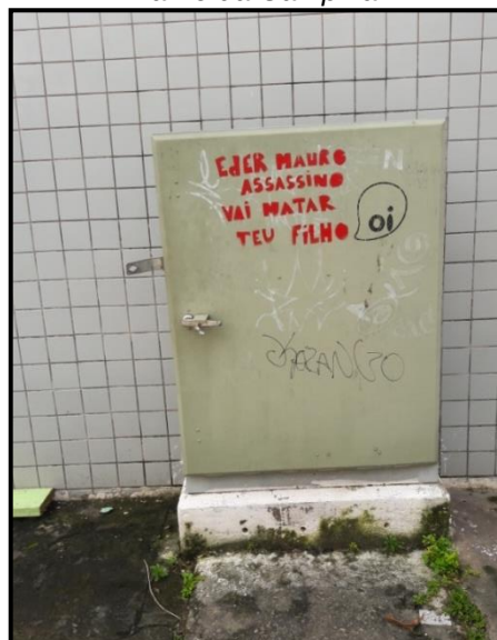
Figura 22: Pixação de protesto na caixa de controle de telefonia na Travessa São Francisco, nº 172, Bairro da Campina.
