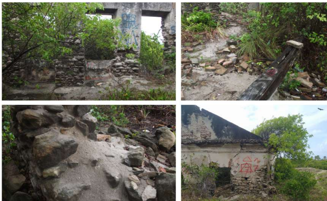
Imagem 48 - Acúmulo arenoso no interior e no exterior das Ruínas do Leprosário da Praia do Francês, Marechal Deodoro - AL.
