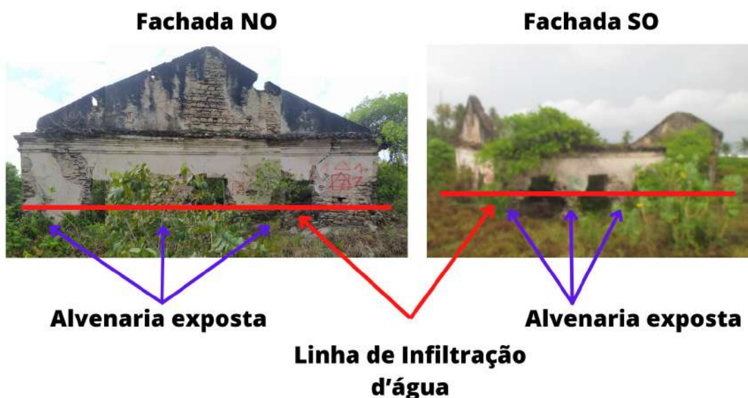
Imagem 40 - Marcação da linha de infiltração d'água nas alvenarias das Ruínas do Leprosário da Praia do Francês, Marechal Deodoro - AL.
