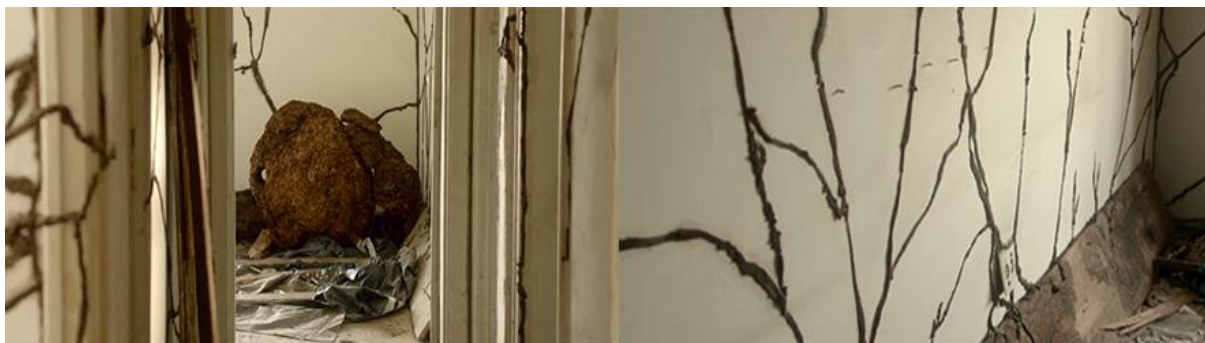
Figura 30: A deterioração dos apartamentos pelos cupins de demolição são perceptíveis e demonstram que a construtora está disposta a tudo para conseguir colocar o edifício Aquarius abaixo.
