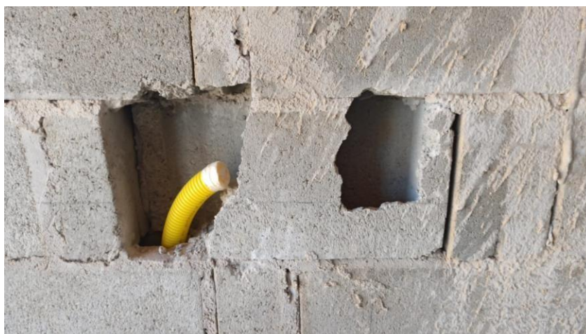
Figura 10 - Quebra de alvenaria na casa número 5.
