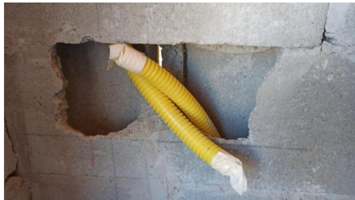
Figura 19 - Quebra de alvenaria na casa número 2.
