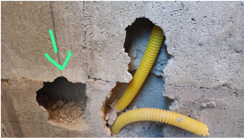
Figura 17 - Quebra de alvenaria na casa número 1.
