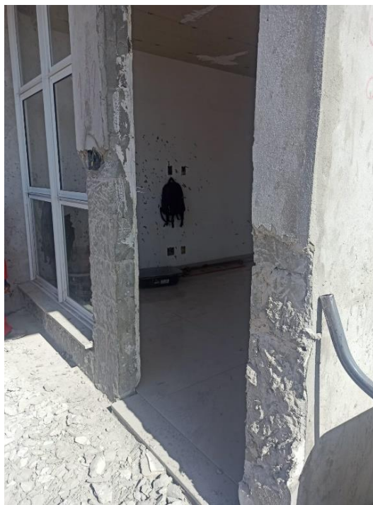
Figura 6 - Escariação do reboco externo.
