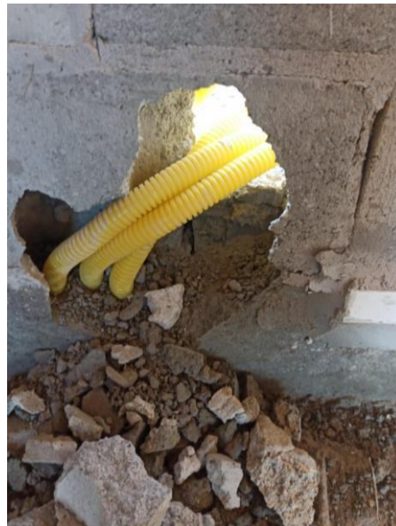
Figura 15 - Quebra de alvenaria na casa número 4.
