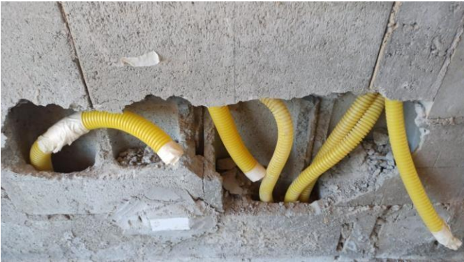
Figura 16 - Quebra de alvenaria na casa número 1.
