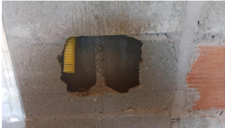
Figura 14 - Quebra de alvenaria na casa número 4.
