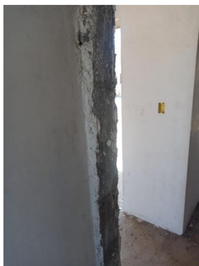
Figura 22 - Problema na espessura para colocação dos alisares.
