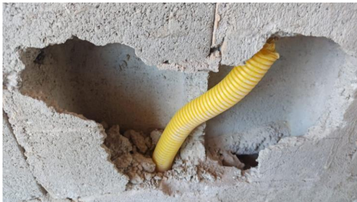
Figura 9 - Quebra de alvenaria na casa número 5.
