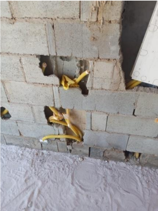
Figura 8 - Quebra de alvenaria na casa número 5
