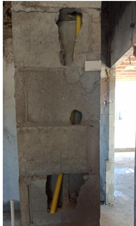
Figura 18 - Quebra na alvenaria casa nº 2.
