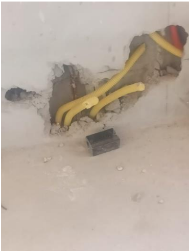
Figura 12 - Quebra de alvenaria na casa número 2.
