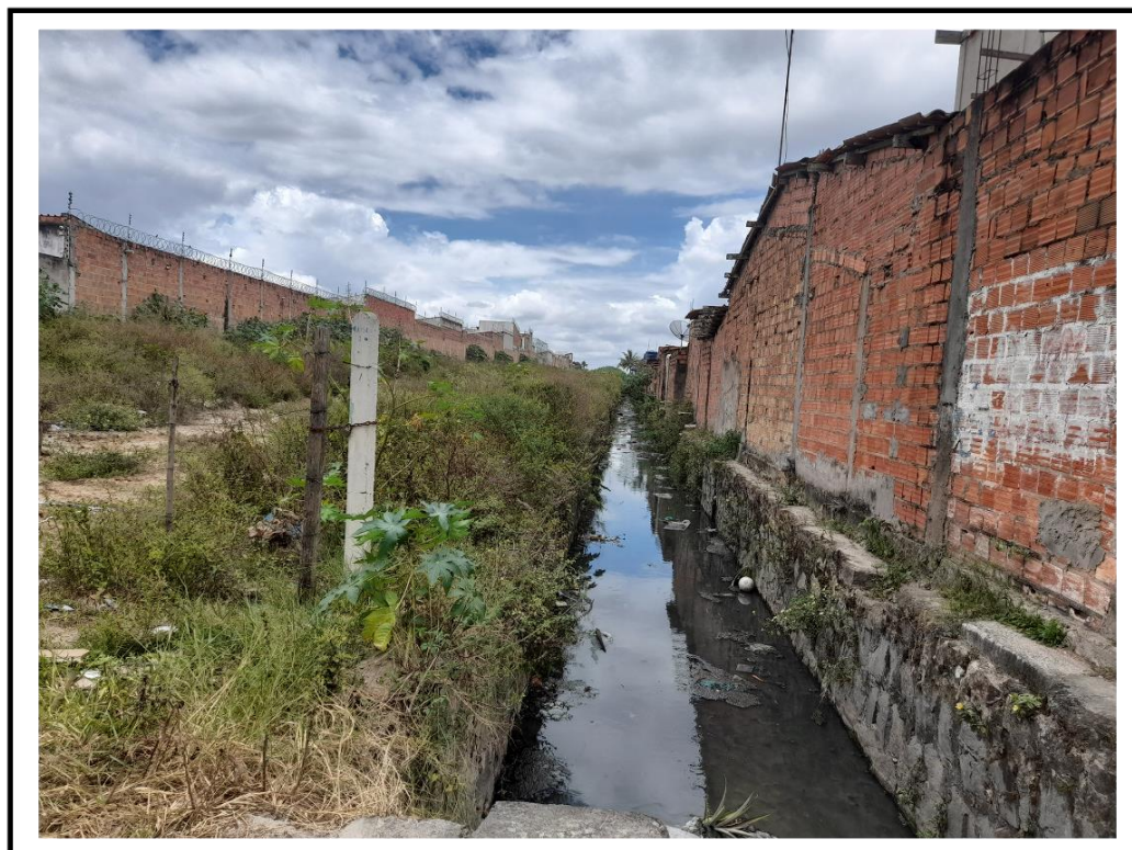
Figura 50– Ocupação nas margens do canal
