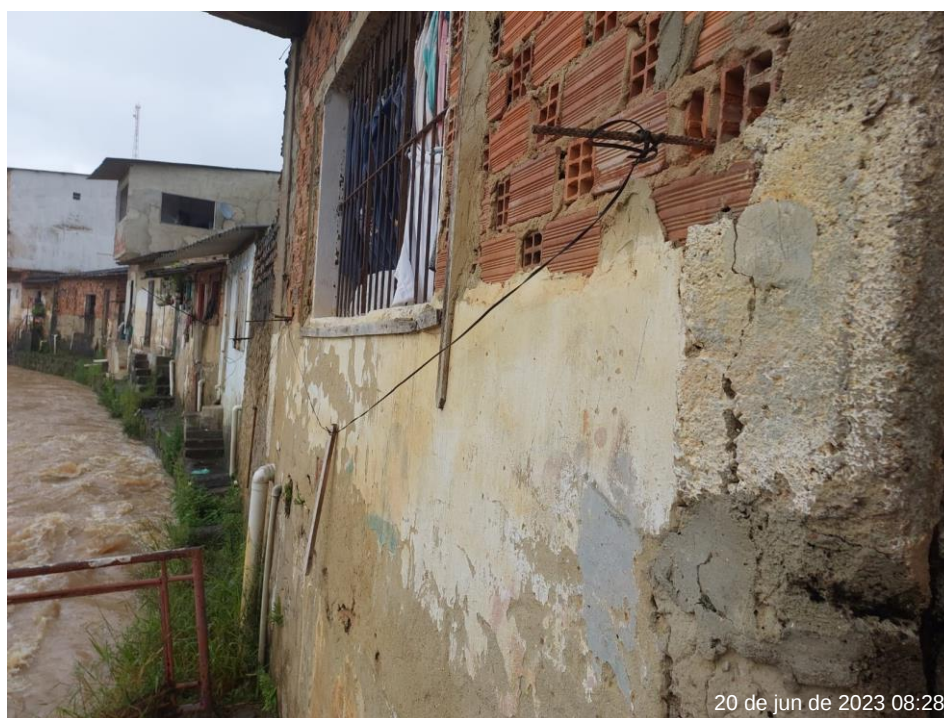
Foto 02: Marcas de elevação do nível do rio, Jacuípe - AL
