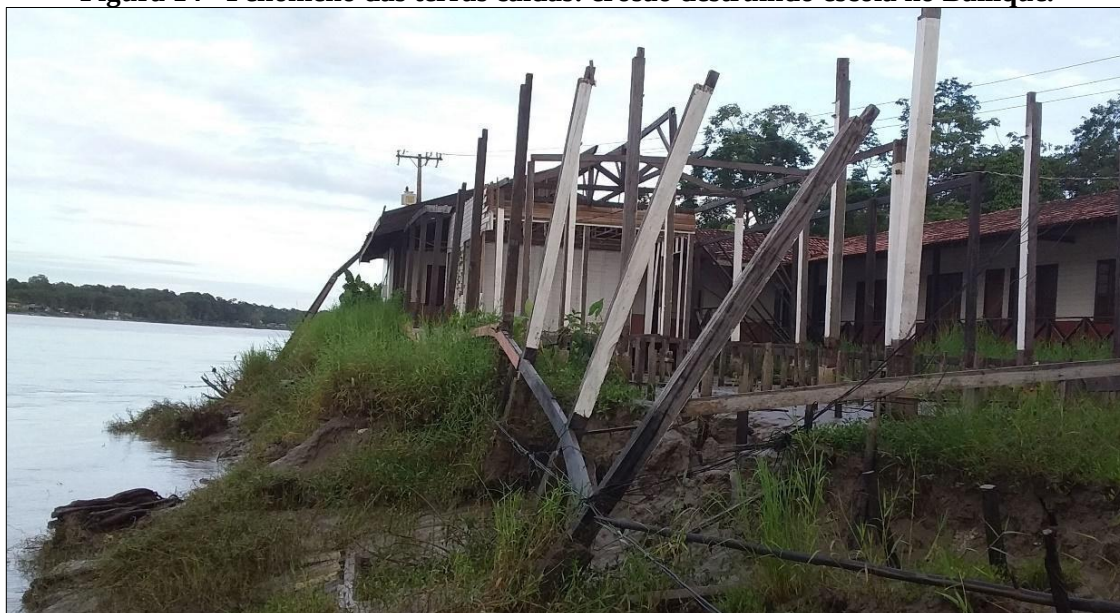
Figura 14 - Fenômeno das terras caídas: erosão destruindo escola no Bailique.
