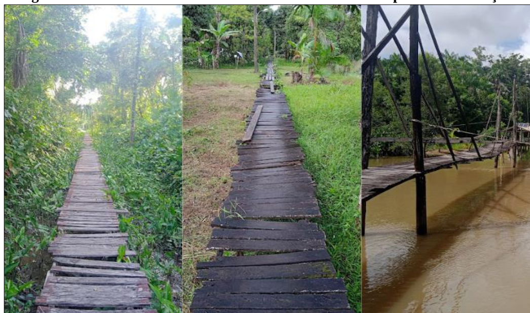
Figura 9 – Passarelas da Comunidade São João Batista em precárias condições.
