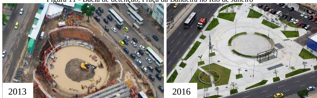
Figura 11 - Bacia de retenção, Praça da Bandeira no Rio de Janeiro
