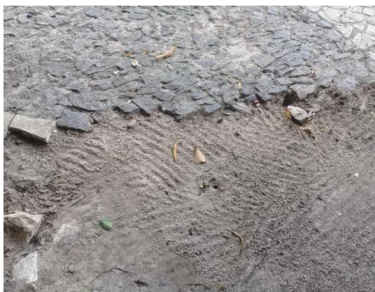
Figura 22 - Pisos quebrados. Fonte: Elaboração própria, 2023.
