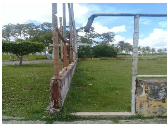
Figura 16 - Parte enferrujada da quadra. Fonte: Elaboração própria, 2023
