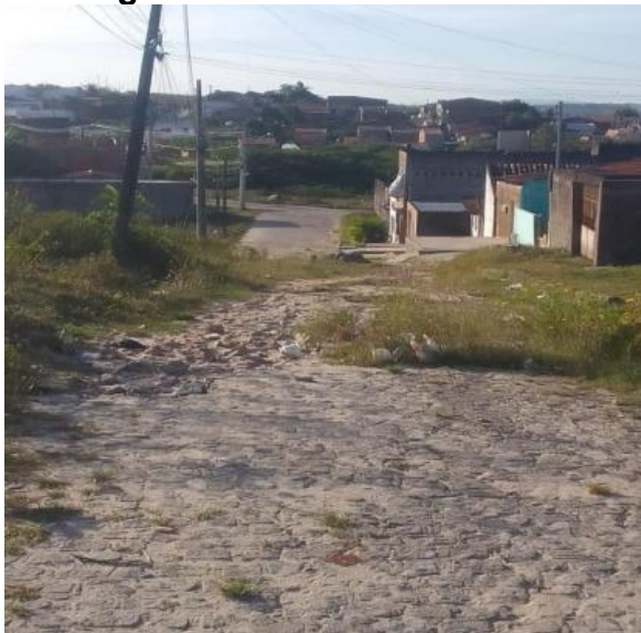
Figura 22 - Rua com buracos
