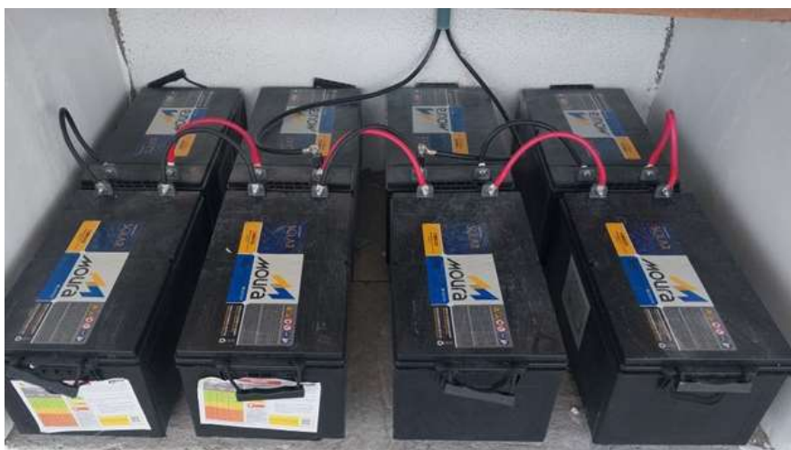
Figura 30 - Conjunto de baterias para armazenamento de energia fotovoltaica.
