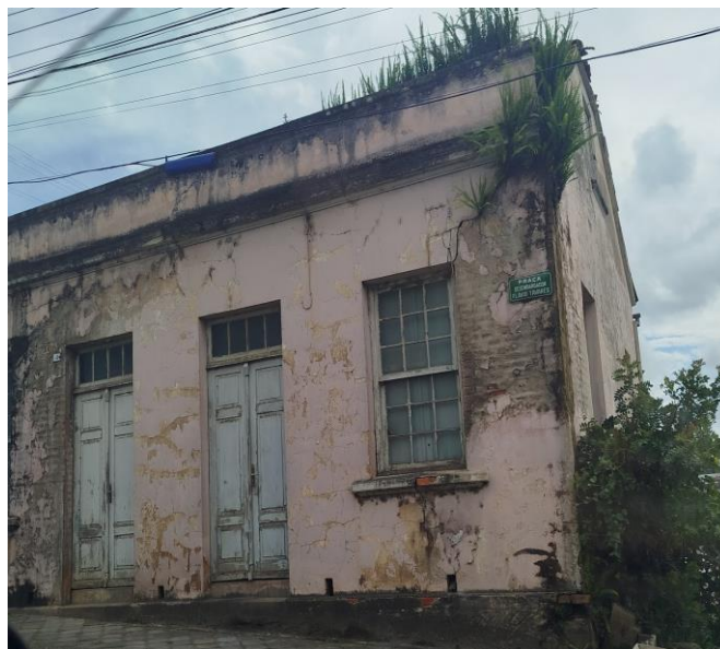
Figura 28. Degradação da fachada do imóvel do Arquivo Público de Mafra.
