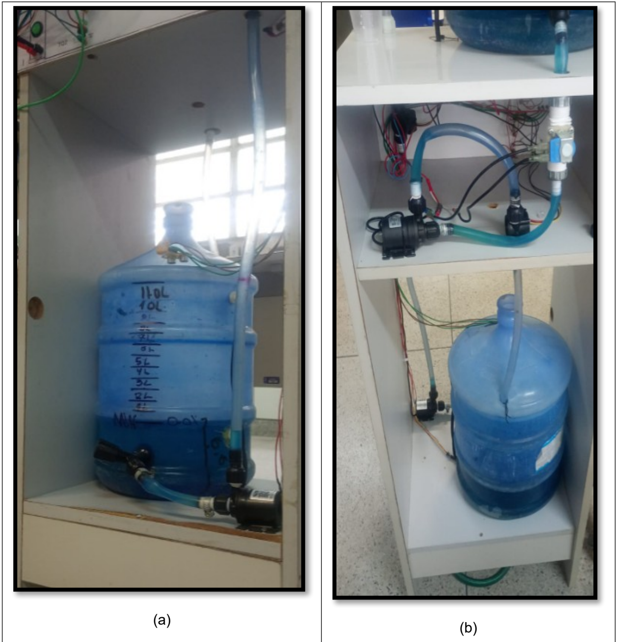
Figura 8: Bomba D'água instalada na planta didática: (a) responsável por abastecer o tanque 1 e (b) responsável por abastecer o tanque 2.
