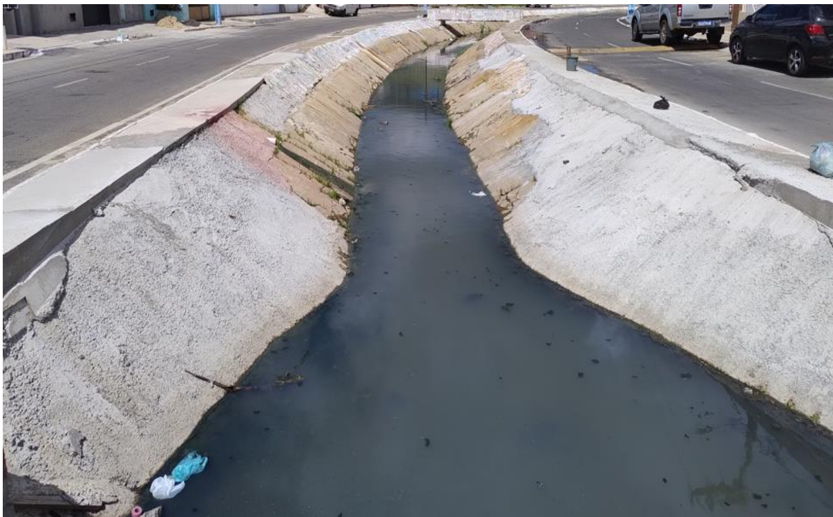
Figura 46: Bairro Prisco Viana – Canal ao longo da avenida periodicamente alagada, 2025.
