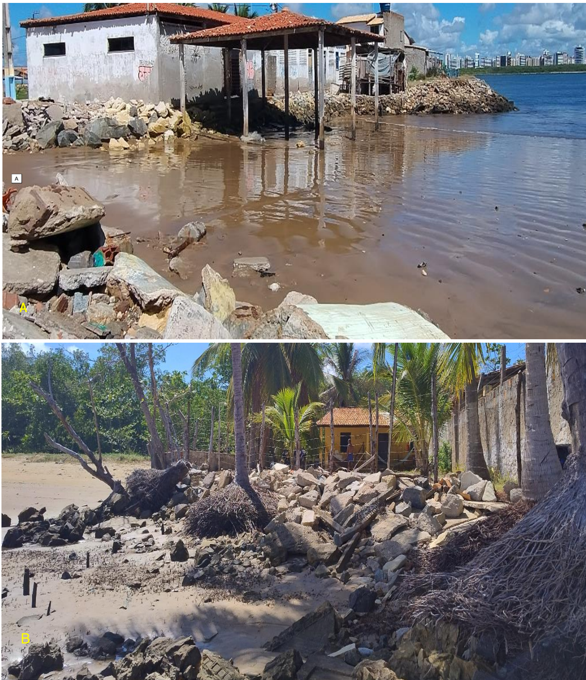
Figura 44 A, B e CB: Bairro Atalaia Nova – Erosão marinha e barreiras de contenção para conter avanço da água.
