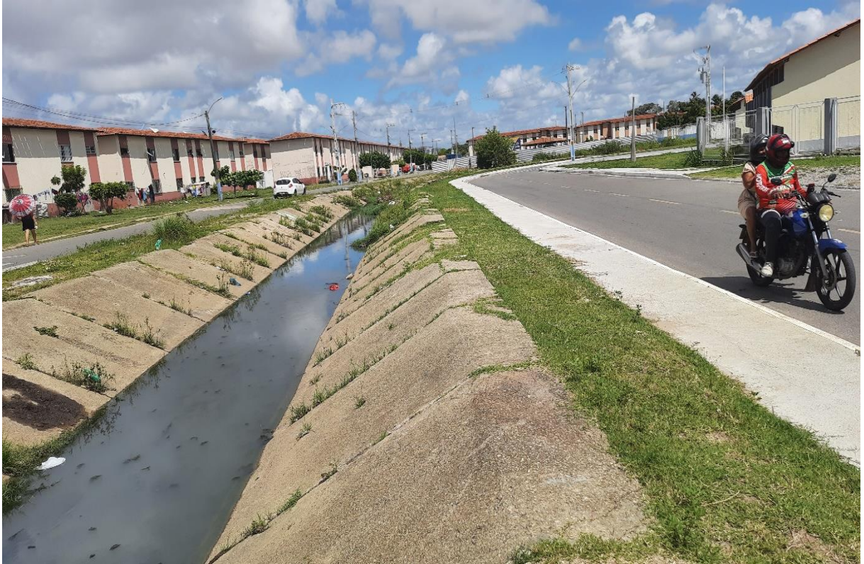
Figura 50: Bairro Moisés Gomes - Córrego nas adjacências das residências, 2025.
