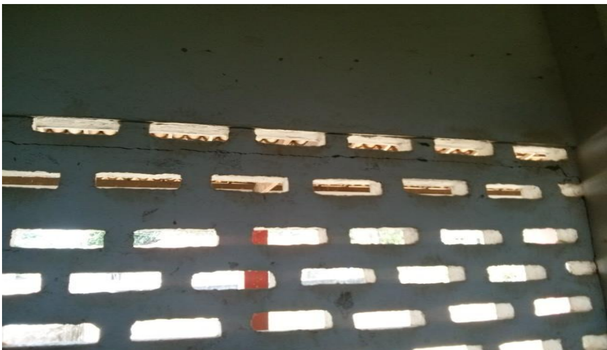
Fotografia 2: Sala de aula com rachadura, 2015.
