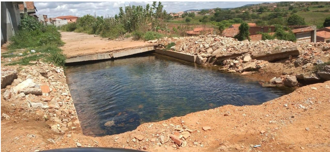
Figura 7 - Parte danificada do canal, sem a devida cobertura e reparo da estrutura.
