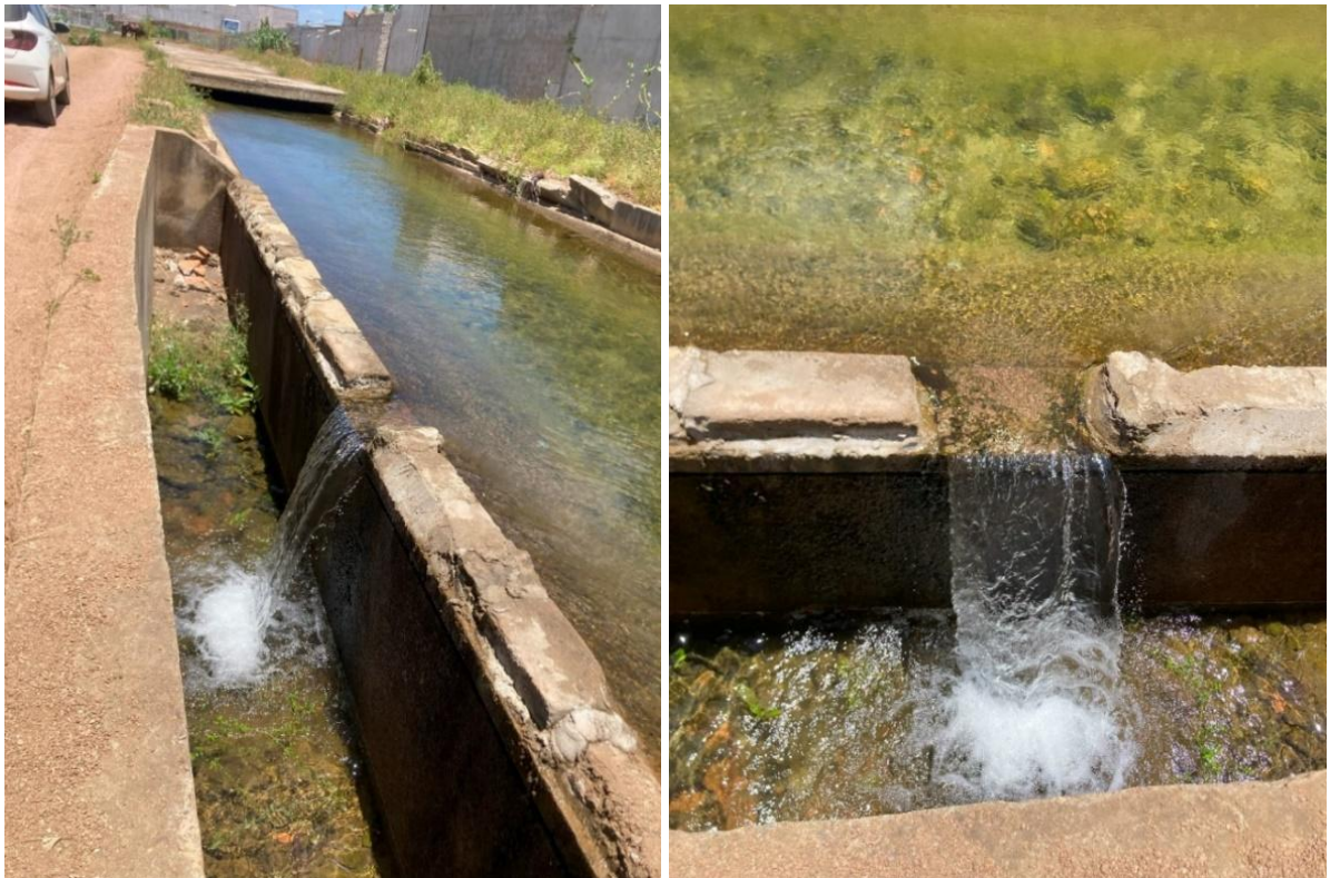
Figura 4 - Vazamento irregular no extravasor do canal principal.
