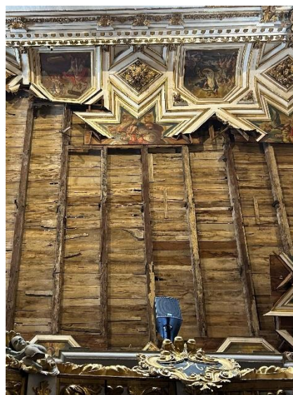
Figura 02 – Detalhe do forro da Igreja de São Francisco que desabou
