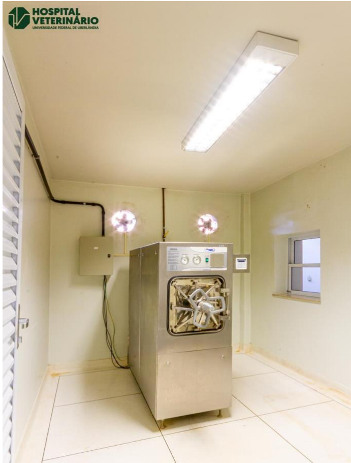
Figura 17: Sala de esterilização do HV-UFU. Fonte: Administração do Hospital, 2025.
