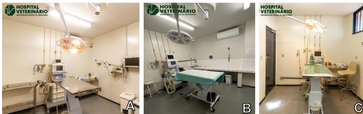
Figura 21: Centros cirúrgicos do HV-UFU apresentando torre de luz, aparelho de anestesia inalatória, monitor multiparamétrico, oxigênio e ar comprimido encanado para ventilação mecânica. A. Centro cirúrgico 1. B. Centro Cirúrgico 2. C. Centro Cirúrgico 3. Fonte: Administração do Hospital, 2025.
