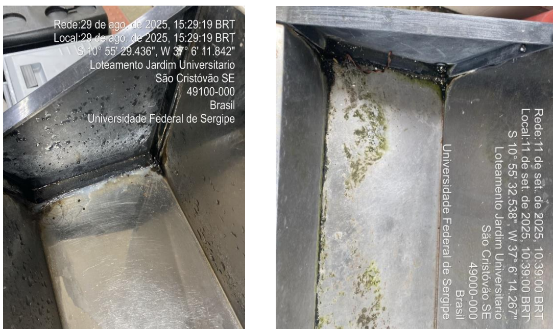
Figura 4 – Registros fotográficos dos bebedouros, evidenciando aqueles em condições inadequadas na bandeja coletora.
