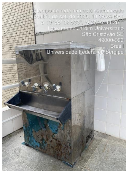
b) Parte frontal e lateral com ferrugens, Did. 6 – 1º andar.
