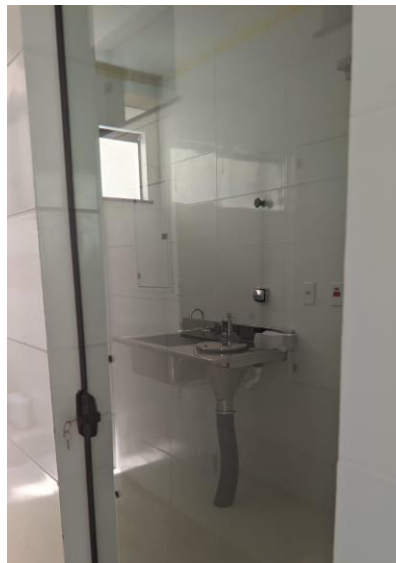
Figura 13: Sala de expurgo para descarte e higienização inicial de materiais. Fonte: Acervo pessoal, 2025.
