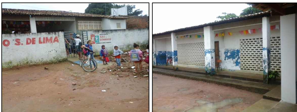
Fotografia 1: Imagens da entrada e do Pátio da escola Municipal Eduardo Siqueira de Lima, 2015.
