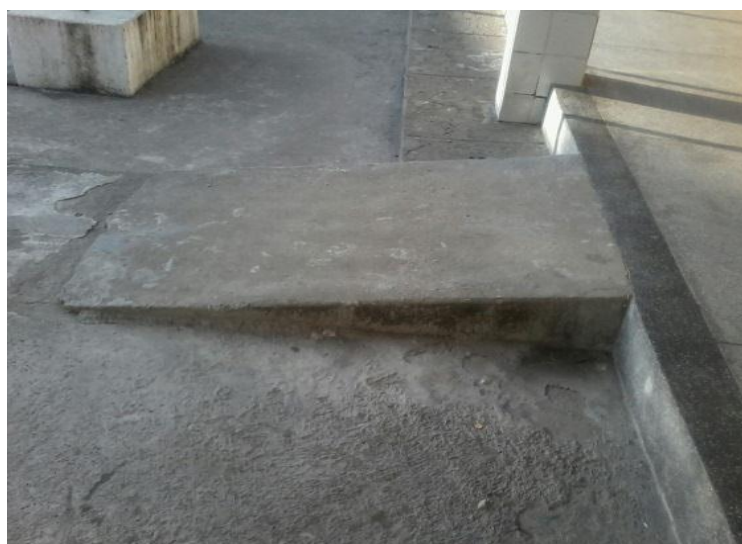
Imagem 6: Única rampa de acesso construída na escola, sem corrimão Fonte: autora :setembro de 2015.
