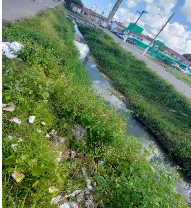
Figura 05 São Cristóvão Eduardo Gomes Canal sem tratamento de esgoto 2025
