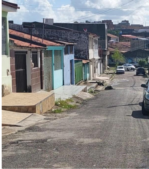
Figura 08 São Cristóvão Eduardo Gomes Rua com Pavimentação precária 2025
