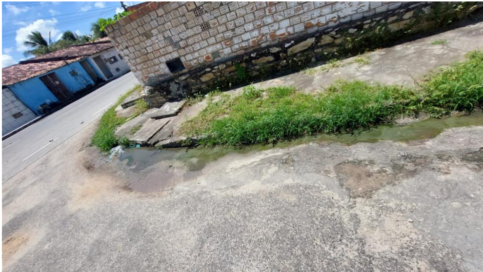
Figura 01 Nossa Senhora do Socorro Marcos Freire III Esgoto a céu aberto 2025
