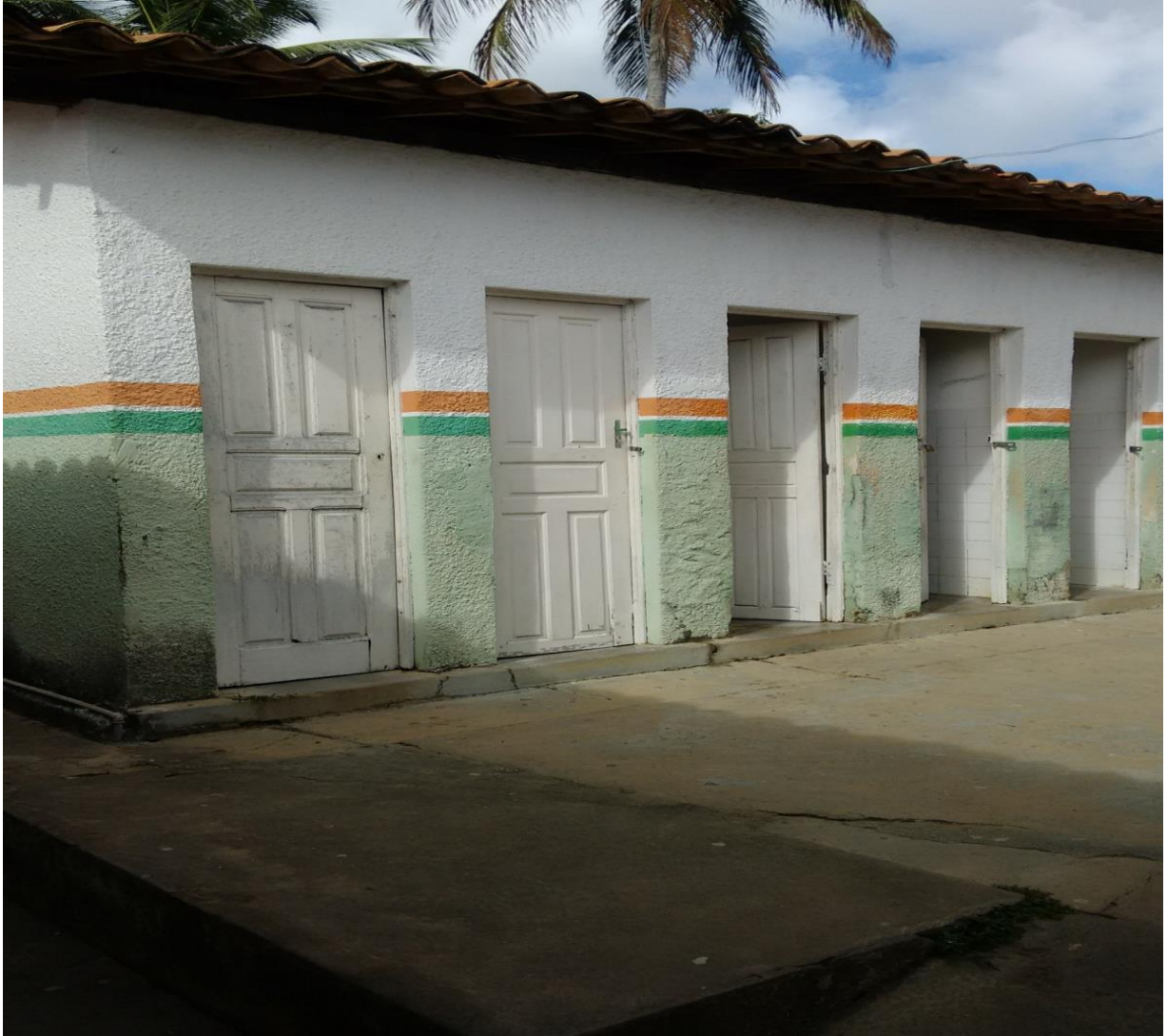
Foto 5: Conjunto de Sanitários acoplados a fossas sépticas
